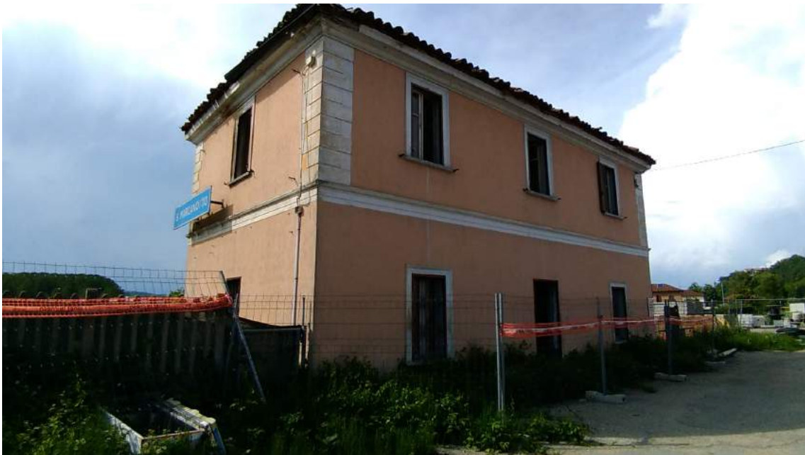
La stazione di S.marzanotto, in evidente stato di abbandono, foto dell'autore.
