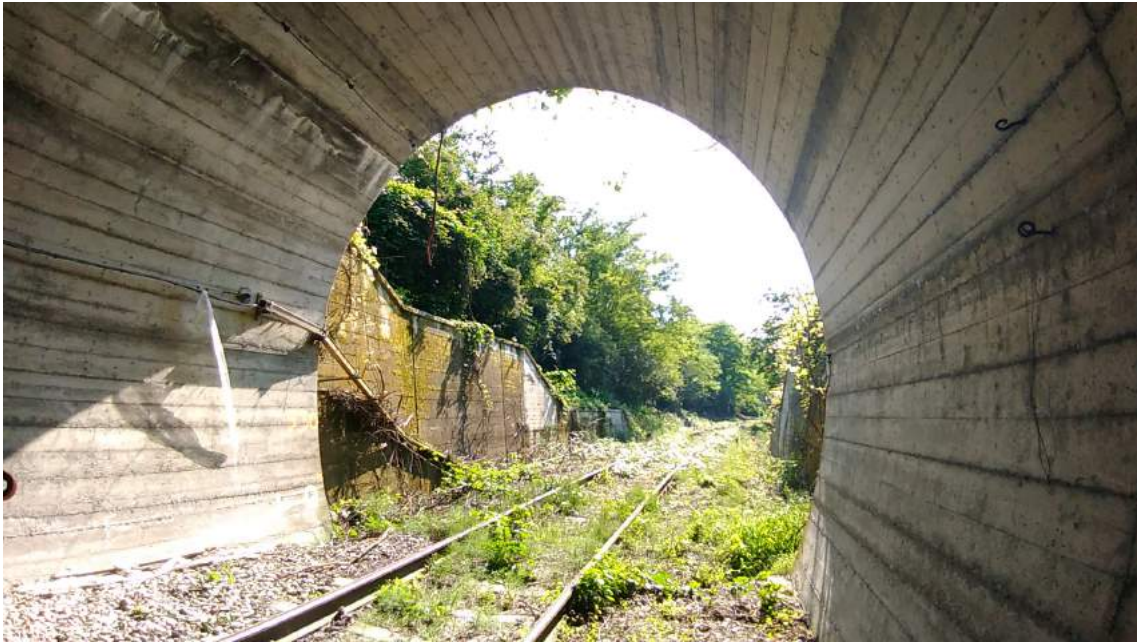
Ingresso alla galleria Martinga con mezzi ferroviari per il ripristino del sedime ferroviario e parziale eliminazione della vegetazione invasiva, foto dell'autore (17 giugno 2018).
