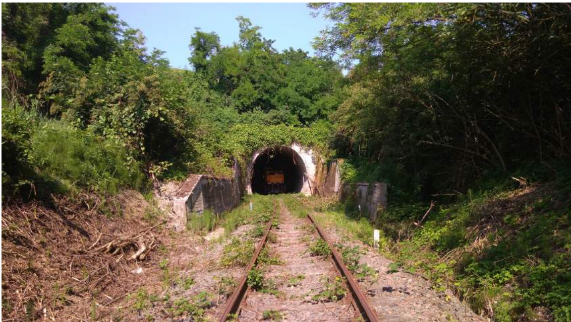
Ingresso della galleria "Martinga" nei pressi della stazione di Barbaresco, foto dell'autore.
