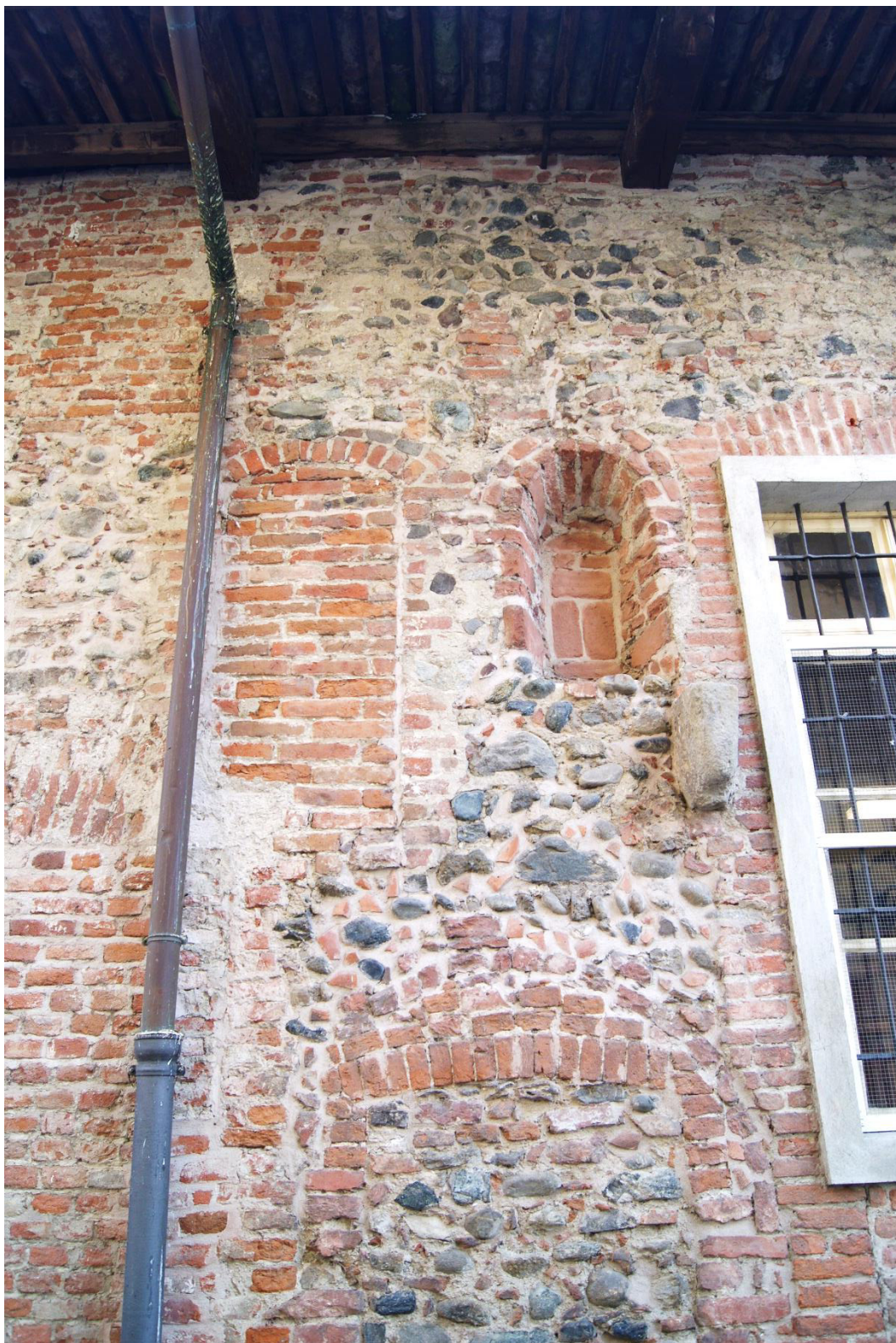
FIGURA 12 - LATO OVEST (VERSO PO) DELL'ABBAZIA CON EVIDENTI TAMPONAMENTI
