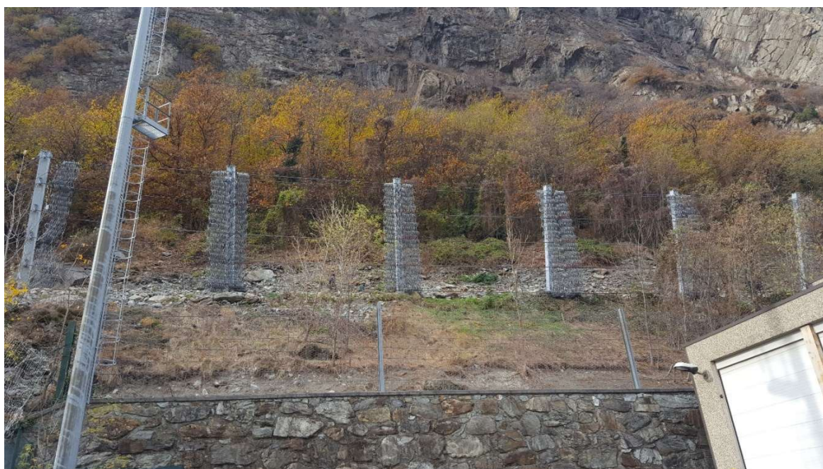
Figura 31 – In primo piano si può notare la barriera paramassi rigida installata precedentemente a protezione dell'area, un'opera chiaramente insufficiente. In secondo piano, i lavori di installazione della nuova struttura (foto scattata il 10 novembre 2017 dal piazzale della stazione di trasferimento rifiuti).
