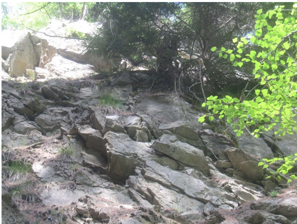
Figura 51 – Parete rocciosa con elevato grado di fratturazione, nella zona sovrastante l'area di intervento nel sito di Aymavilles.
