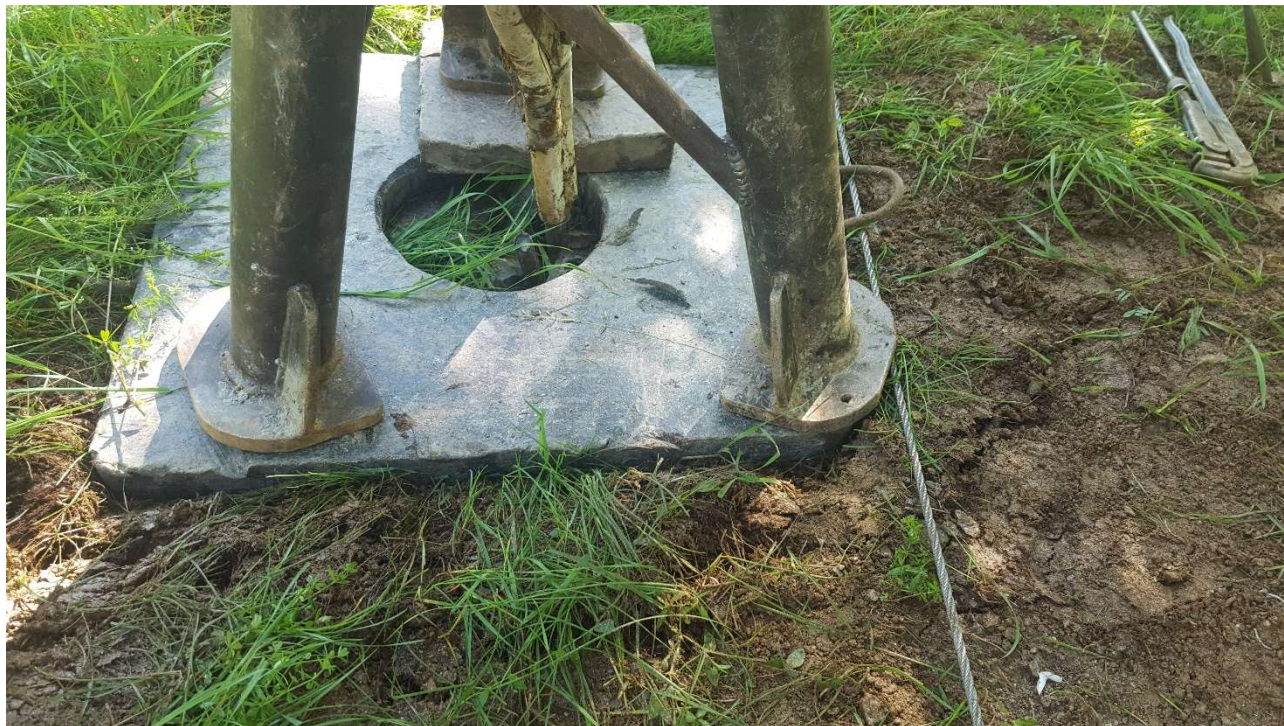
Figura 64 – Spaccature nel terreno durante la prova di collaudo dell'ancoraggio nel sito di Valtournenche, avvenuta il 10 agosto 2018.
