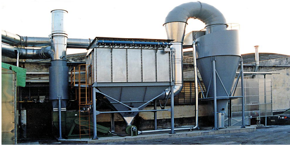
Figura 2.7: Filtro a maniche e ciclone nell'impianto di aspirazione [10]
