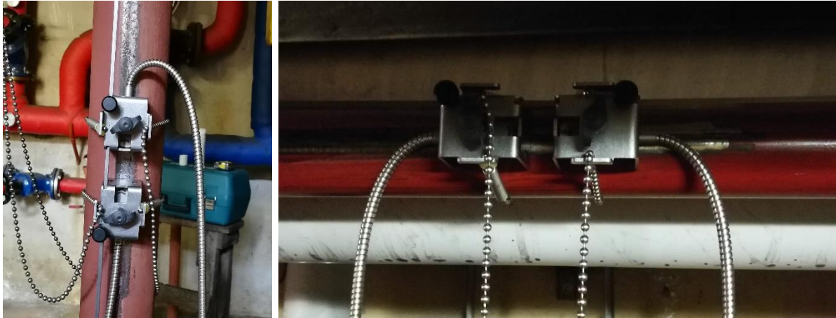
Figura 79: Disposizione verticale (a sinistra) ed orizzontale (a destra) dei sensori.
