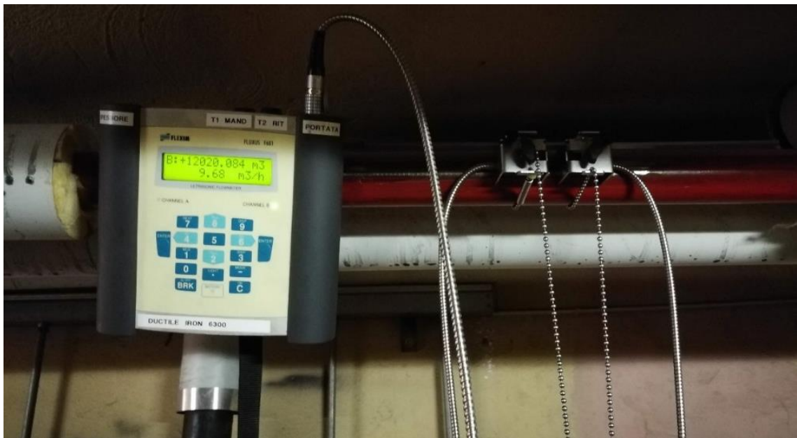
Figura 80: Installazione completa del misuratore di portata clamp-on Iren
