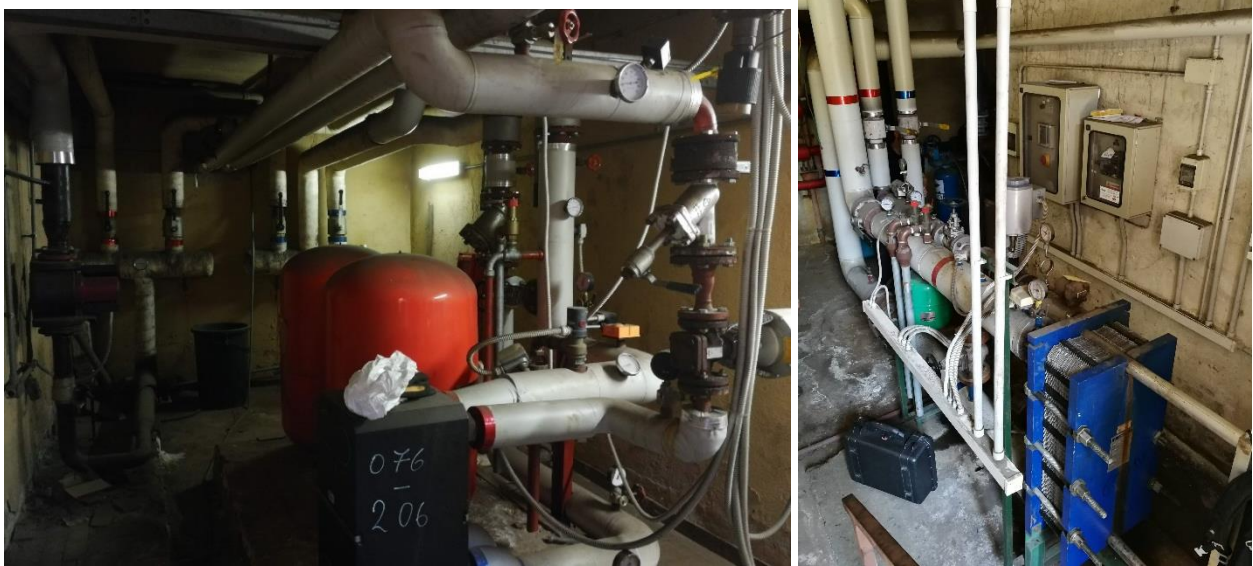
Figura 75: Sottostazioni selezionate per la verifica di taratura dei contatori
