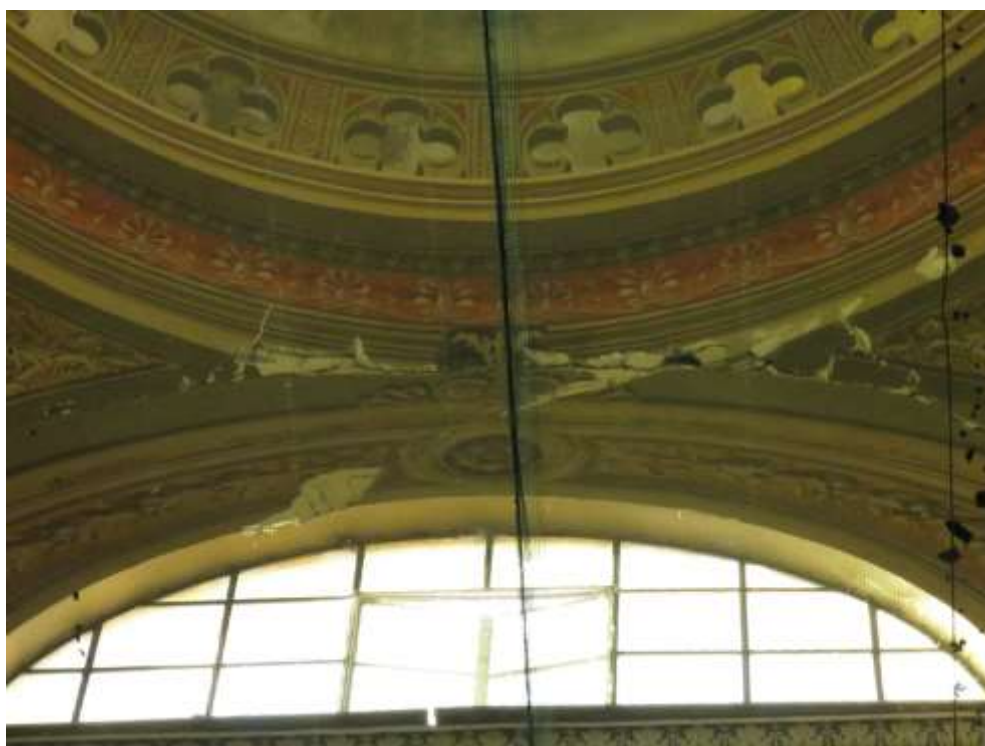
Figura 14 Lesioni dell'abside (rif. fotografie acquisite durante un sopralluogo da parte del team del Politecnico di Torino)
