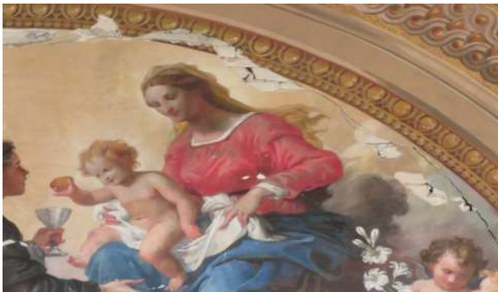
Figura 11 Dettaglio delle lesioni presenti sull'arco del Cappellone di San Nicola (rif. fotografie acquisite durante un sopralluogo da parte del team del Politecnico di Torino)
