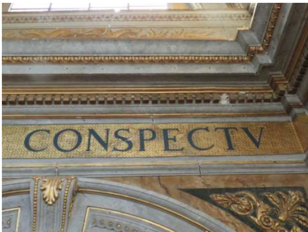
Figura 9 Lesione della cornice decorativa interna alla facciata, lato sinistro (rif. fotografie acquisite durante un sopralluogo da parte del team del Politecnico di Torino)
