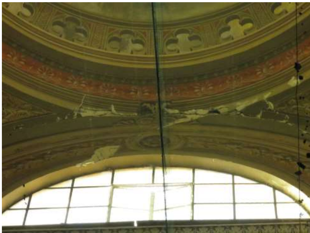
Figura 78 Lesioni dell'abside (rif. fotografie acquisite durante un sopralluogo da parte del team del Politecnico di Torino)
