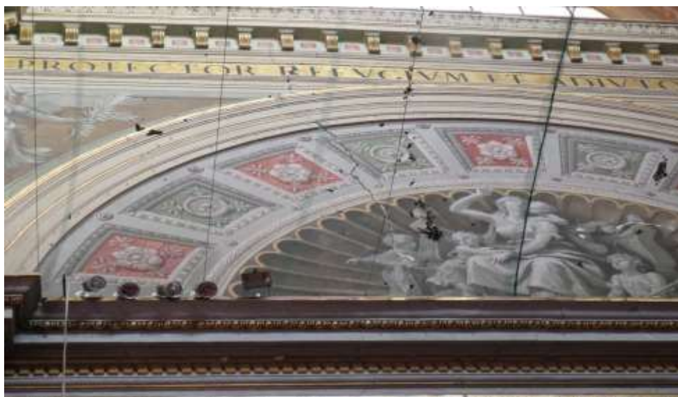
Figura 76 Lesioni dell'abside (rif. fotografie acquisite durante un sopralluogo da parte del team del Politecnico di Torino)
