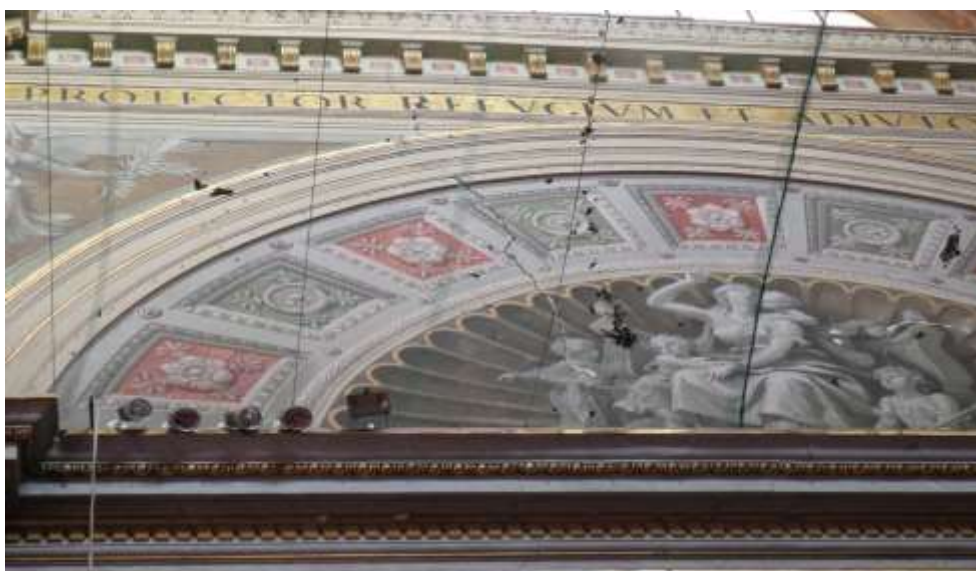
Figura 12 Lesioni dell'abside (rif. fotografie acquisite durante un sopralluogo da parte del team del Politecnico di Torino)
