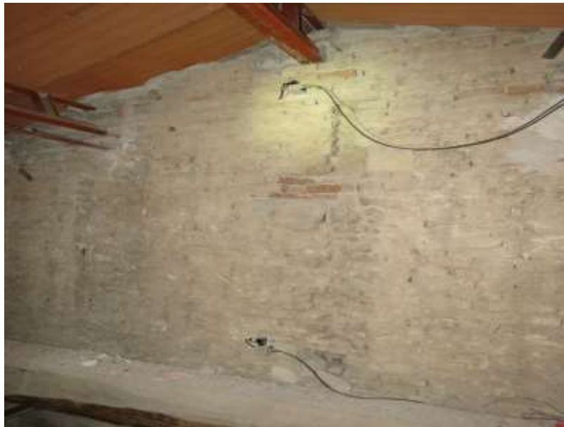
Figura 28 Muro di controfacciata di scarsa qualità implica scarso collegamento con il tetto (rif. fotografie acquisite durante un sopralluogo da parte del team del Politecnico di Torino)
