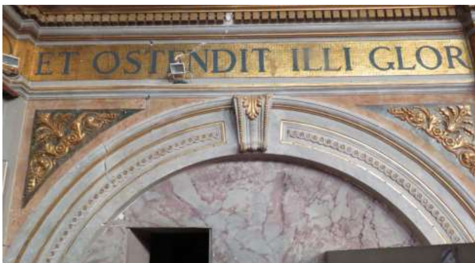
Figura 8 Lesione della cornice decorativa interna della facciata, lato destro (rif. fotografie acquisite durante un sopralluogo da parte del team del Politecnico di Torino)
