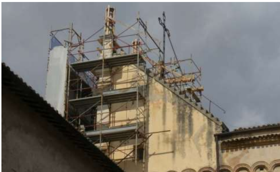
Figura 7 Vista laterale della facciata e relative fessure presenti (rif. fotografie acquisite durante un sopralluogo da parte del team del Politecnico di Torino)
