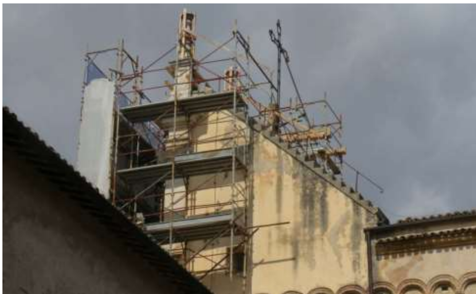
Figura 72 Vista laterale della facciata e relative fessure presenti (rif. fotografie acquisite durante un sopralluogo da parte del team del Politecnico di Torino)
