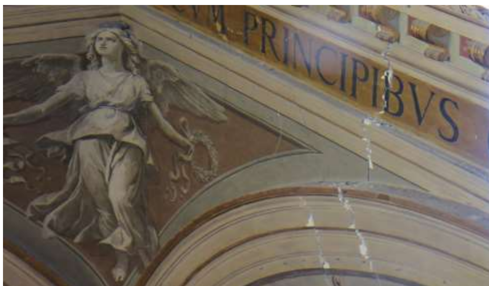
Figura 10 Dettaglio lesioni sull'arco del Cappellone (sopralluogo da parte del team del Politecnico di Torino)
