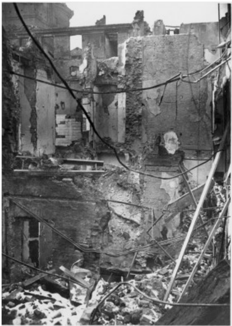
Fig. 15 Via Giuseppe Garibaldi. Edificio sven- trato dai bombardamenti dell'incursio- ne aerea dell'8 dicembre 1942. (ASCT, UPA 2638_9C03-6)
