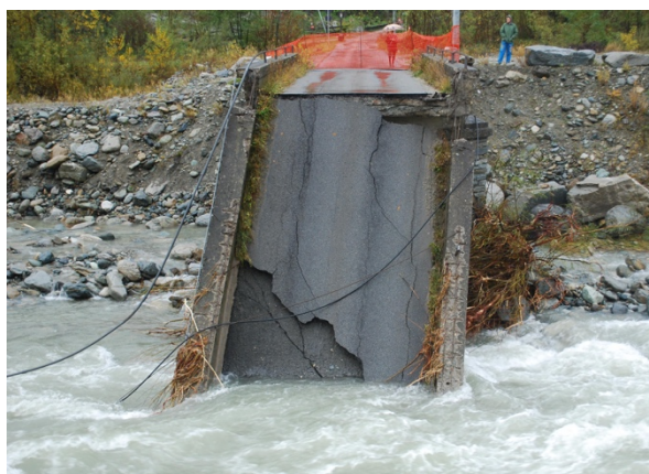
Fig. 12 – Alluvione 2008, crollo del ponte dell'Albertenga (AFPT – archivio fotografico Provincia di Torino)
