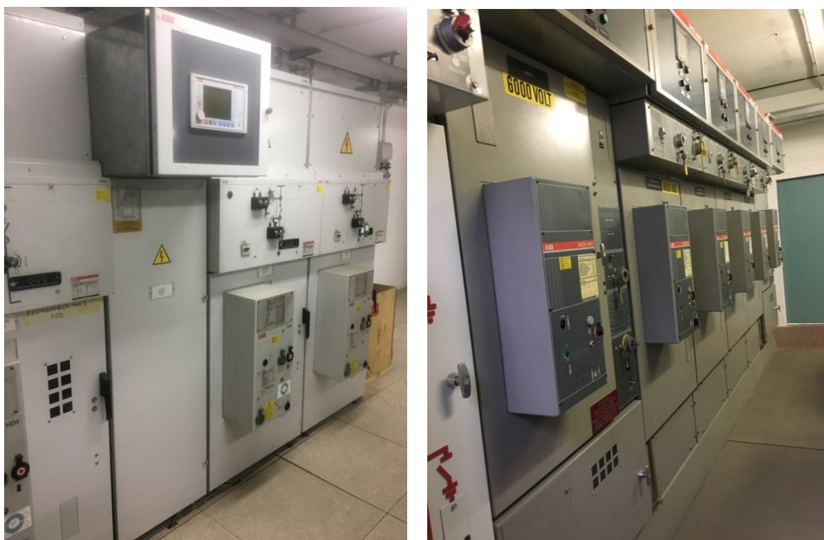
Figura 2.3.6 – Cabine elettriche: CE 3 (sinistra) e CE1 (destra), P.O. Martini
