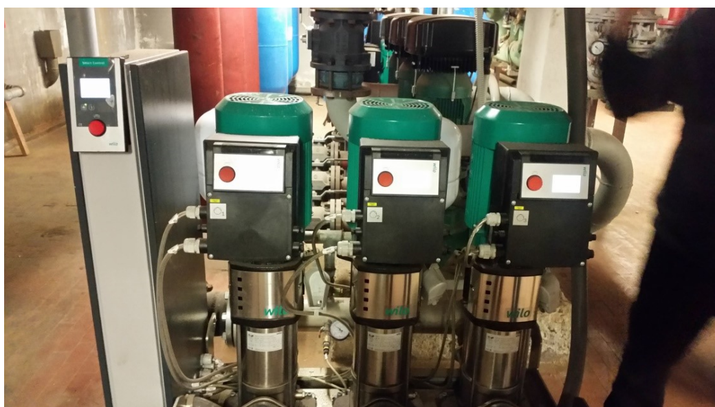
Figura 2.3.3 – Circolatori con inverter, Centrale termica principale P.O. Martini
