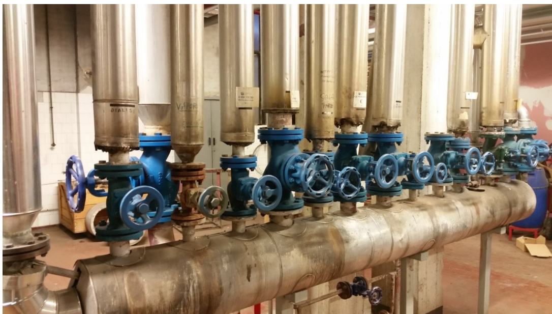
Figura 2.3.4 – Collettori di mandata, Centrale termica principale P.O. Martini
