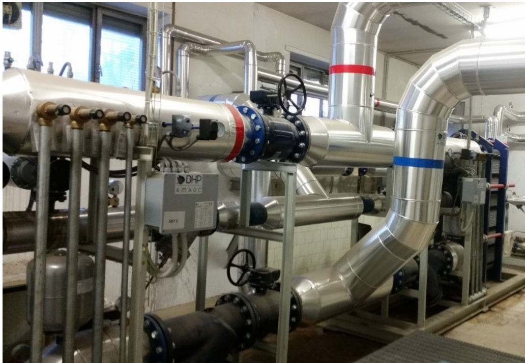
Figura 2.3.1 – Stazione teleriscaldamento, Centrale termica principale P.O. Martini
