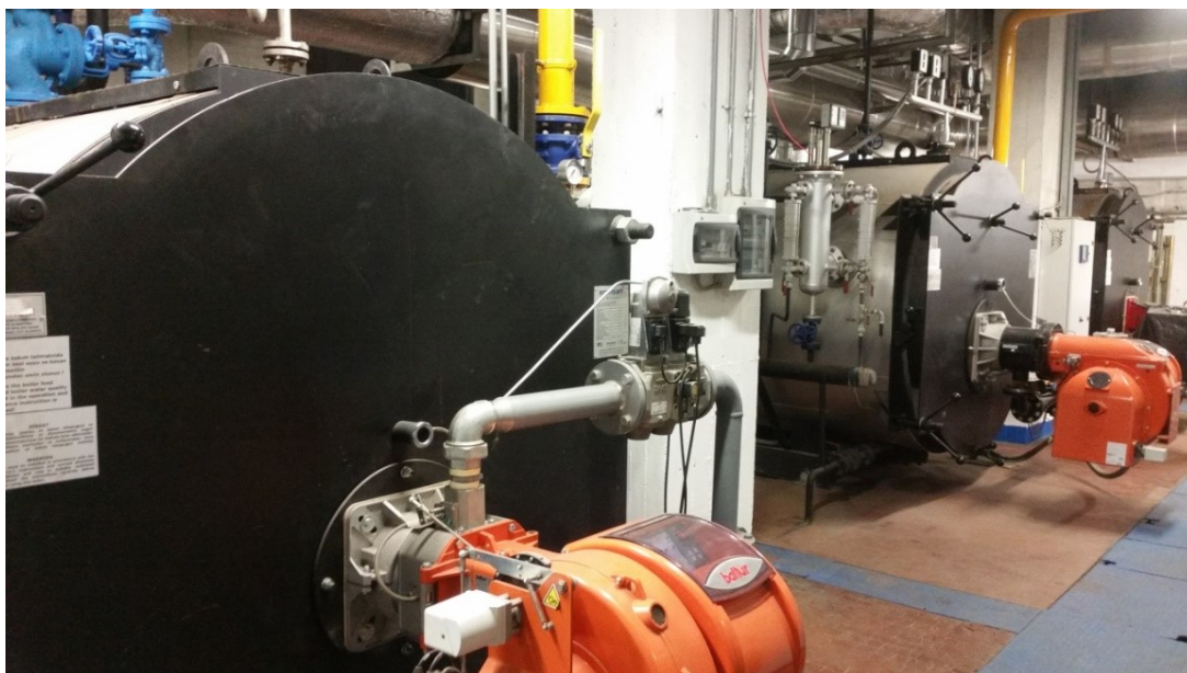
Figura 2.3.2 – Generatori a vapore, centrale termica principale P.O. Martini
