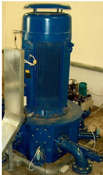
Figura 2.8: Foto della cassa della turbina e del generatore elettrico, concessione di API S.p.a.
