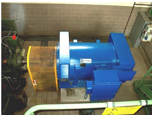
Figura 2.13: Foto del generatore della minicentrale di Inverso Pinasca, concessione di API S.p.a.
