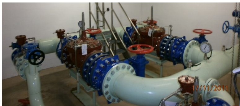
Figura 2.5: Foto del by-pass, concessione di API S.p.a.
