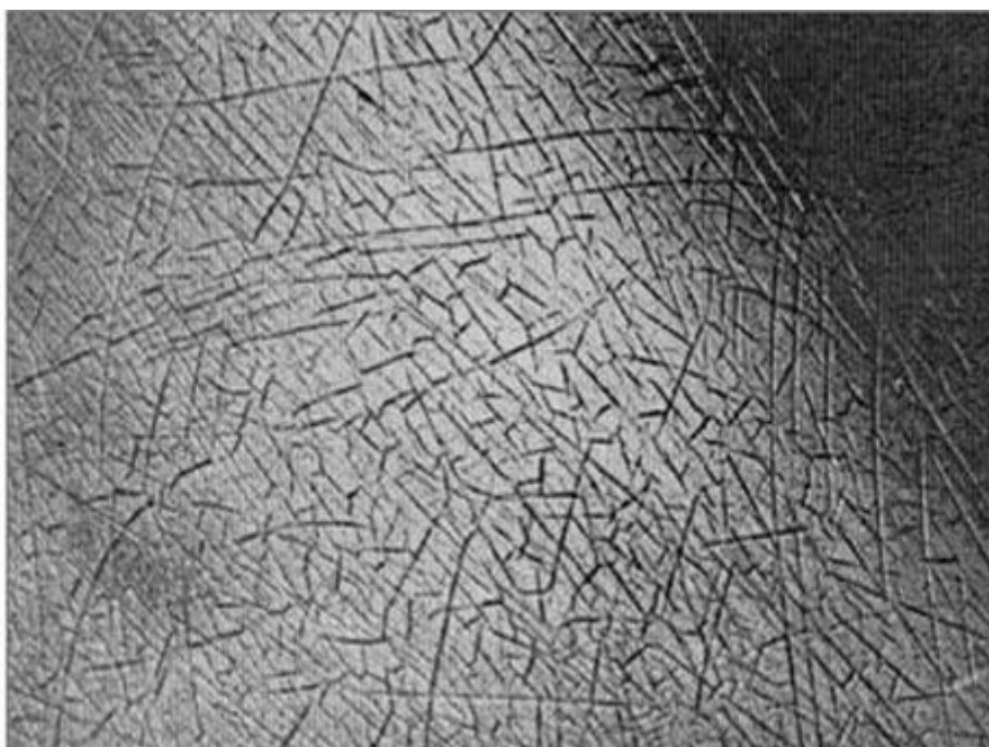
Cavillatura ( o screpolatura superficiale o screpolatura reticolata) [ EN ISO 4618-2 : 1999 punto 2.13]
