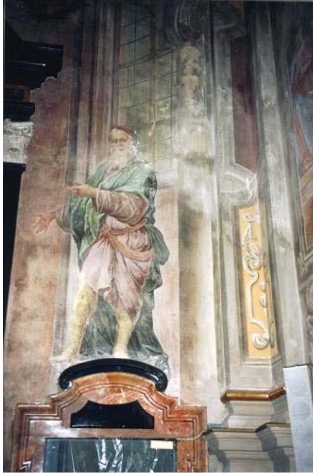
Affresco interno della Chiesa in stato di degrado
