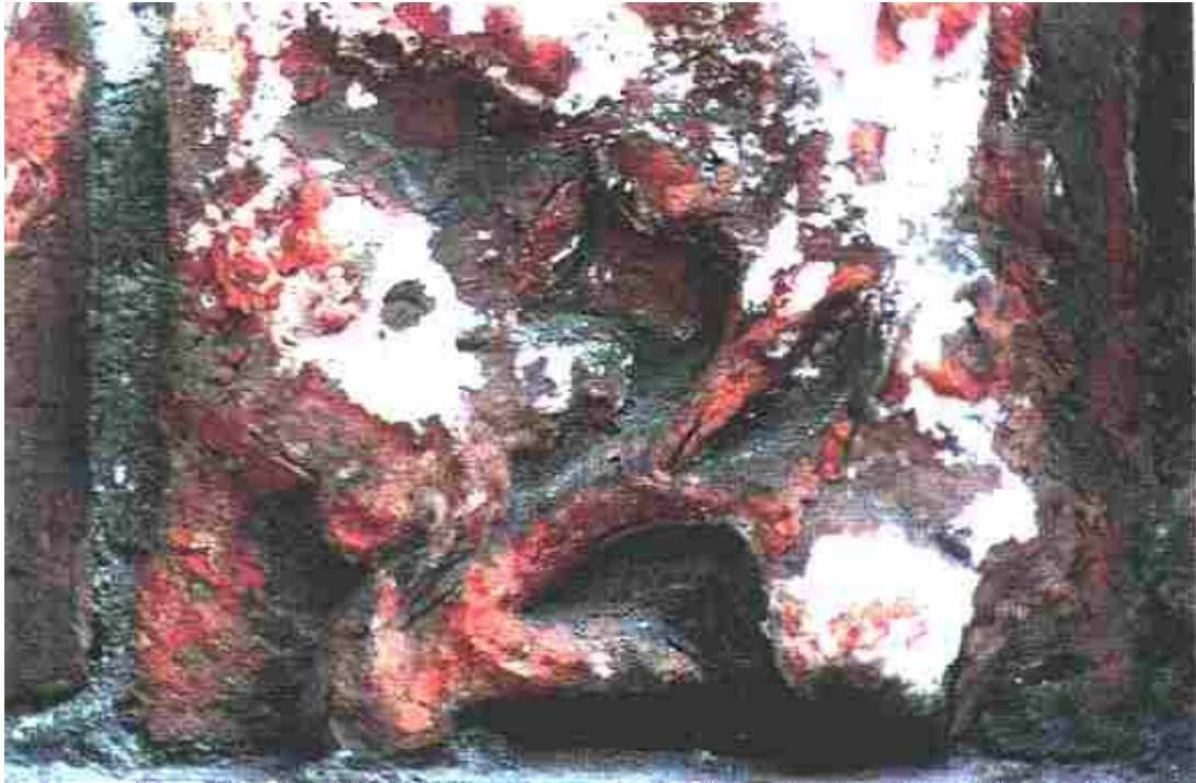
Sant'Antonio di Ranverso (Avigliana - Torino). Effloresceces on the brick
