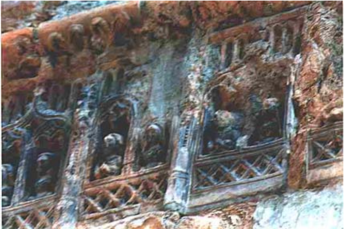
Casa del Conte Verde - Rivoli (Torino) Particolare dello stato di degrado delle formelle
