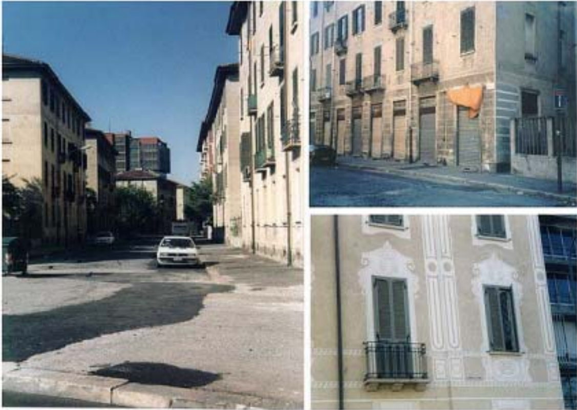
Quartiere di Via Arquata, Torino. Degrado edilizio e qualità' architettonica delle facciate.
