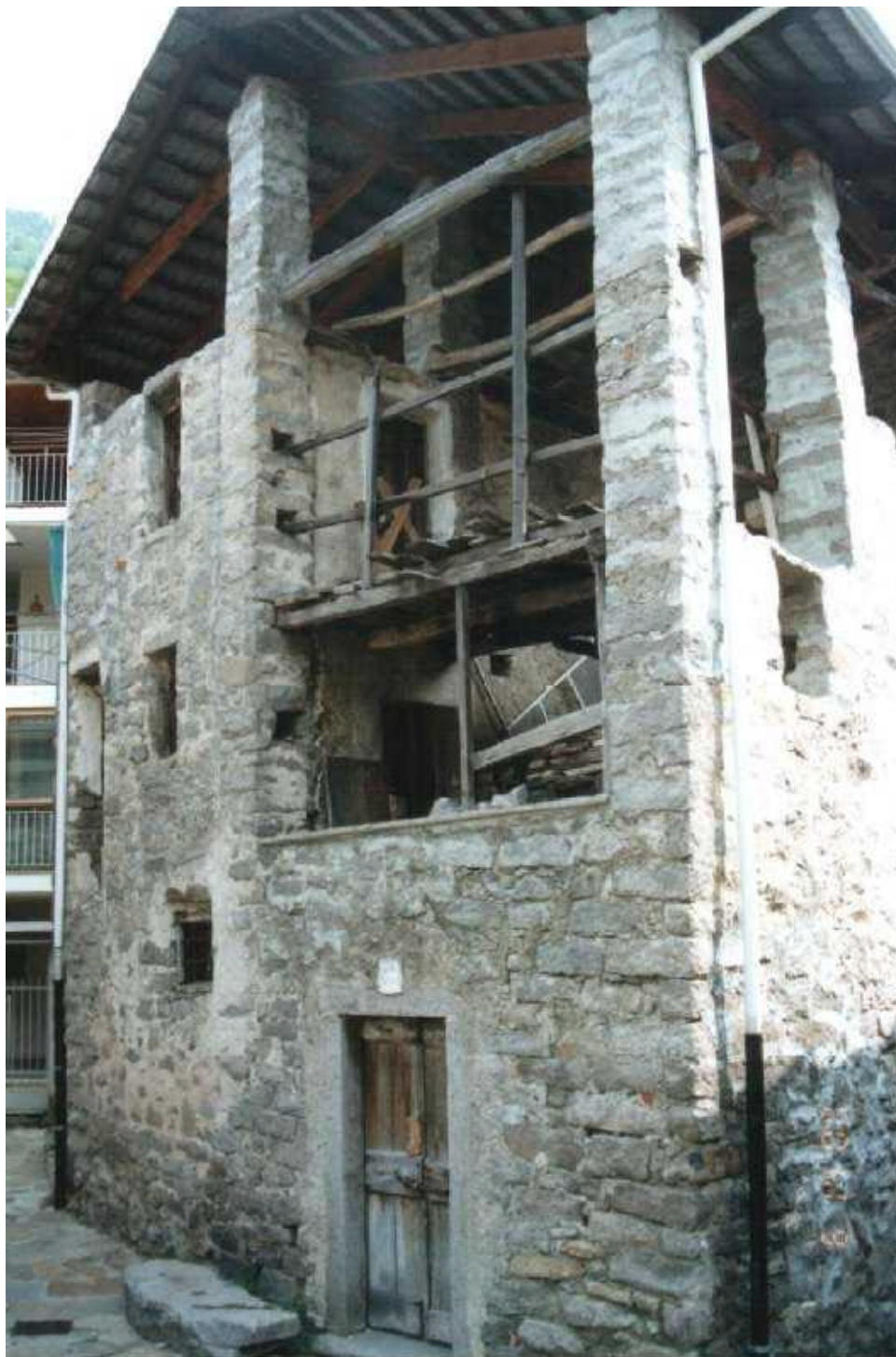
Alta Valle Cervo – tipico esempio di architettura rurale con uso di specifici materiali reperibili sul luogo
