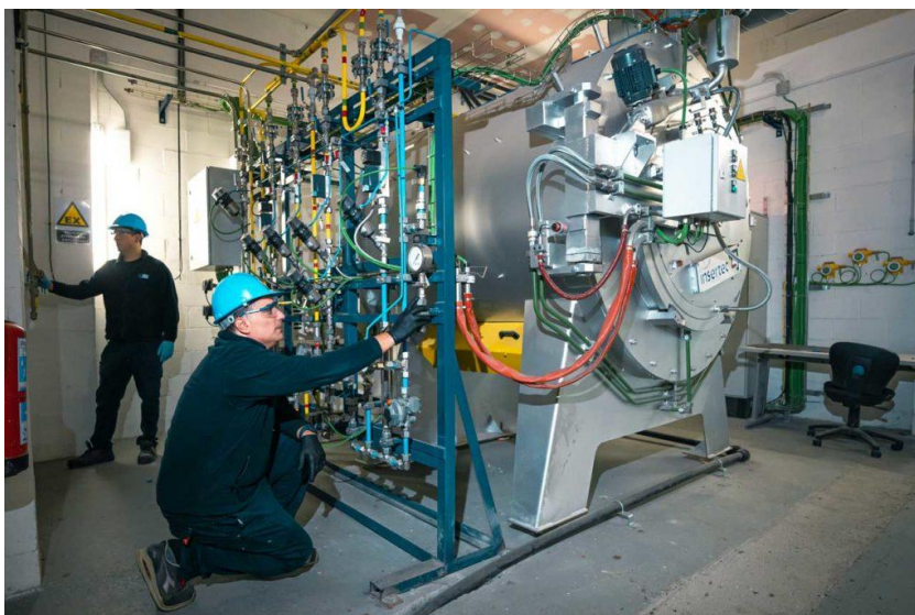
Figure 63: Strumentazione H2SITE necessaria per scindere idrogeno da miscele.
