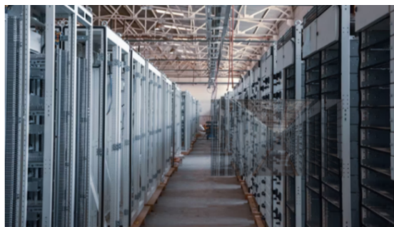
Figura 1.1. Sala server moderna che rappresenta l'ambiente fisico in cui i mainframe operano [14]
