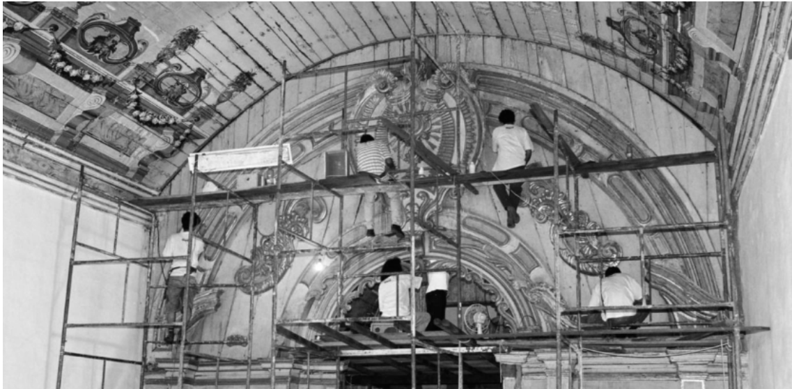
Figure 97 – Restoration of the Main Church of Pirenópolis in 1996. [Source: CAVALCANTE, Sílvio; CAVALCANTE, Neusa. Barro, madeira e pedra: patrimônios de Pirenópolis. 2nd ed. Brasília: IPHAN, 2019.]
