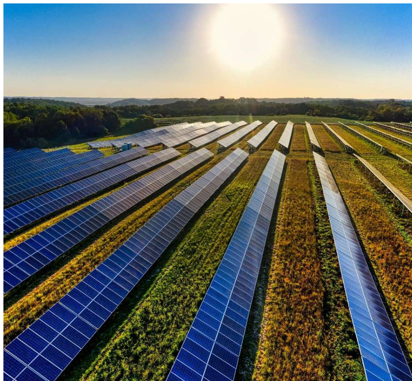
[Figura 25] Impianto PV a struttura fissa
