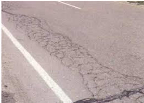
Figura 13: esempio di rottura a pelle di coccodrillo (fessure visibili a occhio nudo)
