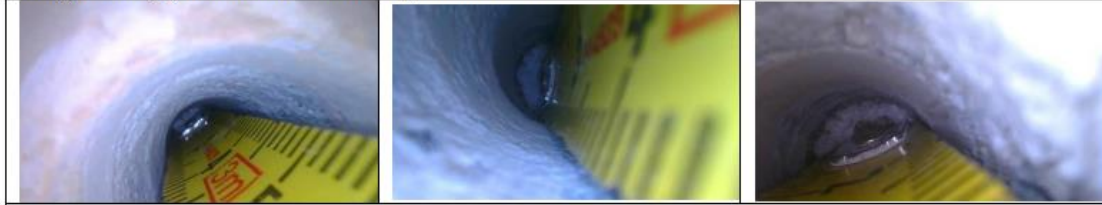
Immagini stratigrafia intradosso solaio – Caldana 3 cm + massetto in cls alleggerito >2 cm
