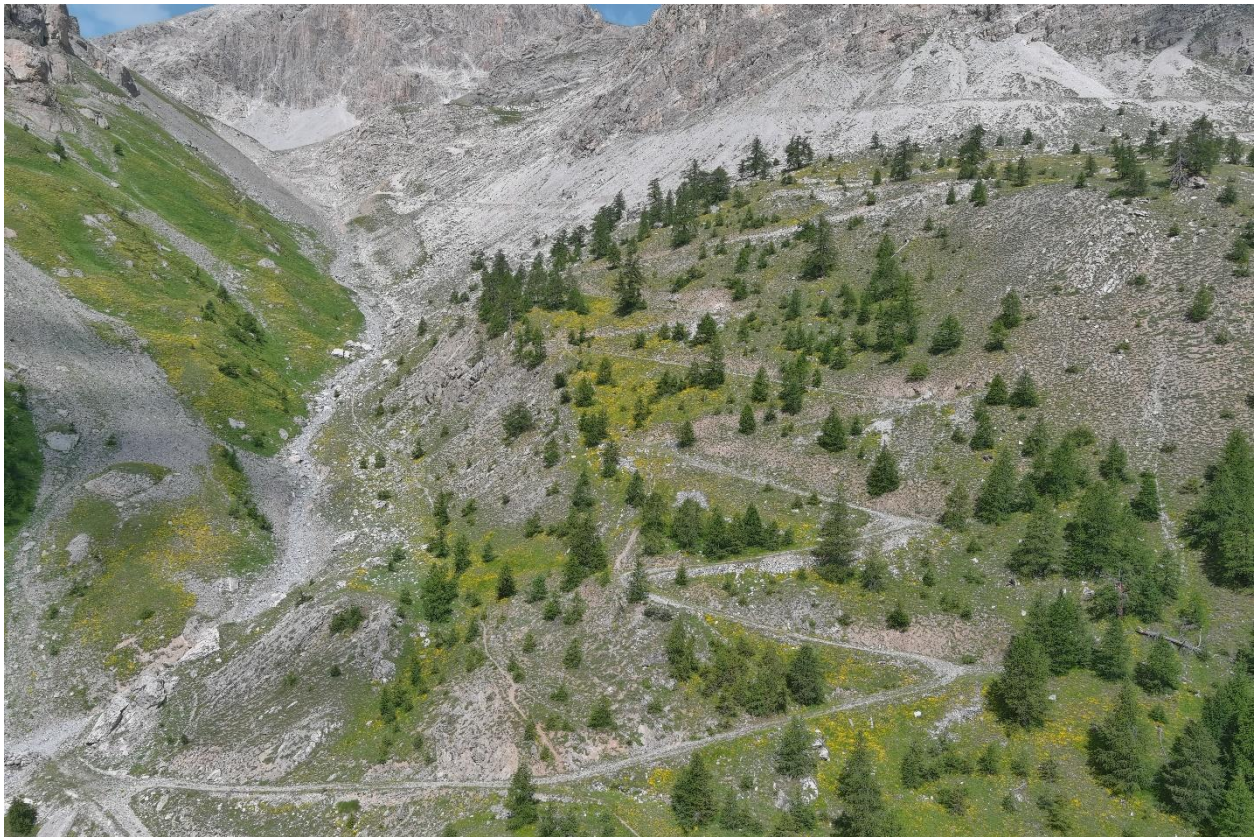
Figura 3.18 Veduta dei tornanti che portano al Colle dello Chaberton. In alto sulla destra si notano i fenomeni di crollo che franano sui versanti. (Foto scattata da drone del CFVAS)
