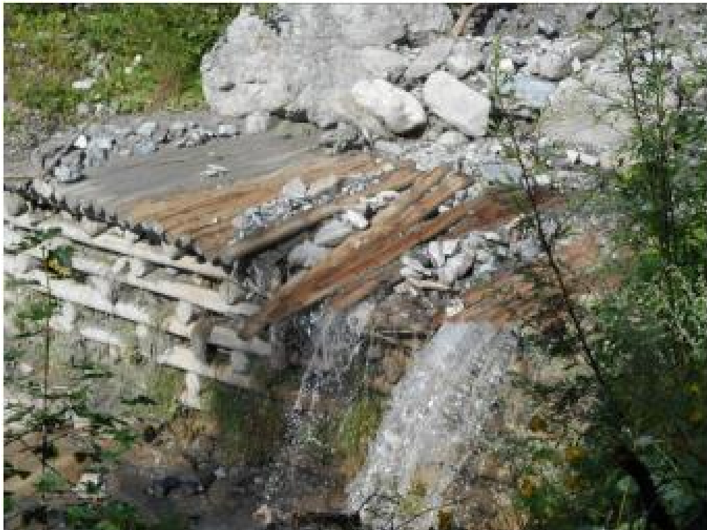
Figura 4.5 Briglia danneggiata nel settore di Grangia Selleta, in seguito al trascinarsi di blocchi di dimensioni centimetriche.
