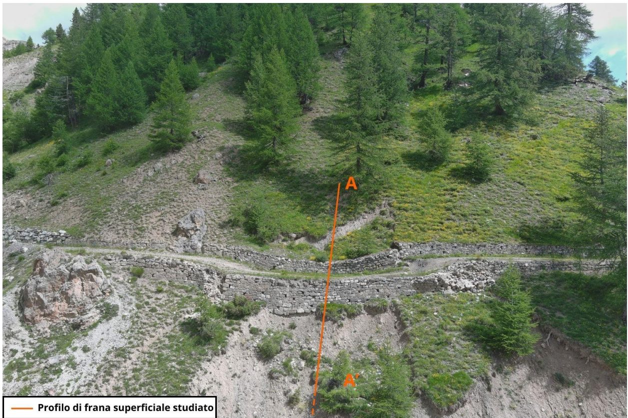
Figura 6.3 Frana superficiale creatasi a partire dalla tension crack presente sopra la strada
