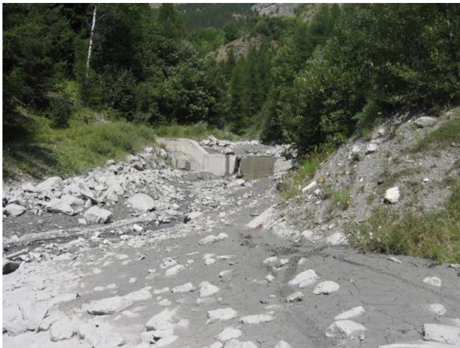
Figura 4.6 Alveo del rio Fenils, in seguito all'evento del 17/07/2015.
