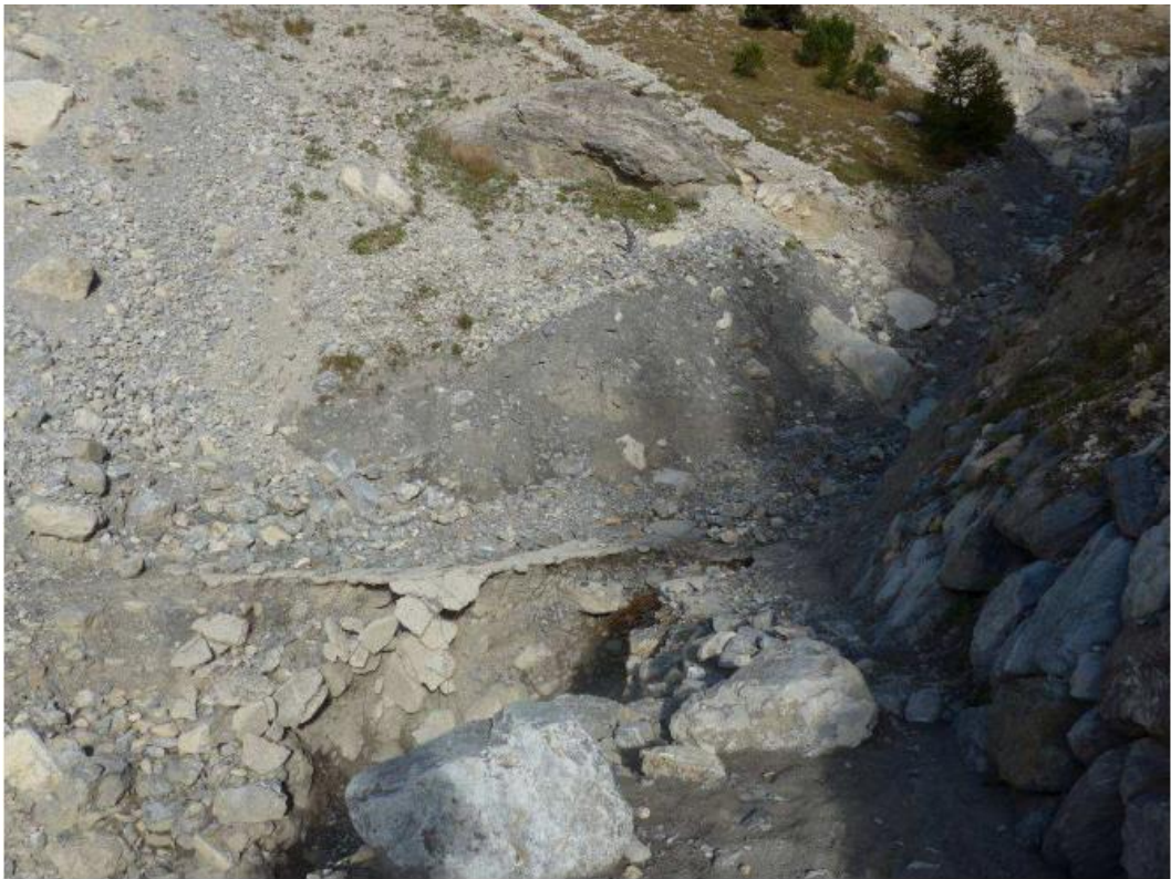
Figura 4.10 Sedime stradale devastato dal debris flow del 01/07/2019.
