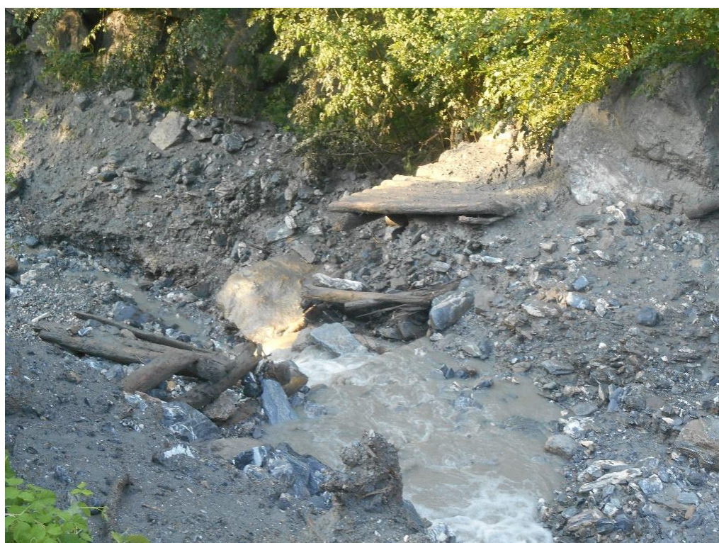
Figura 4.8 Briglia in legno danneggiata in località Sellette.
