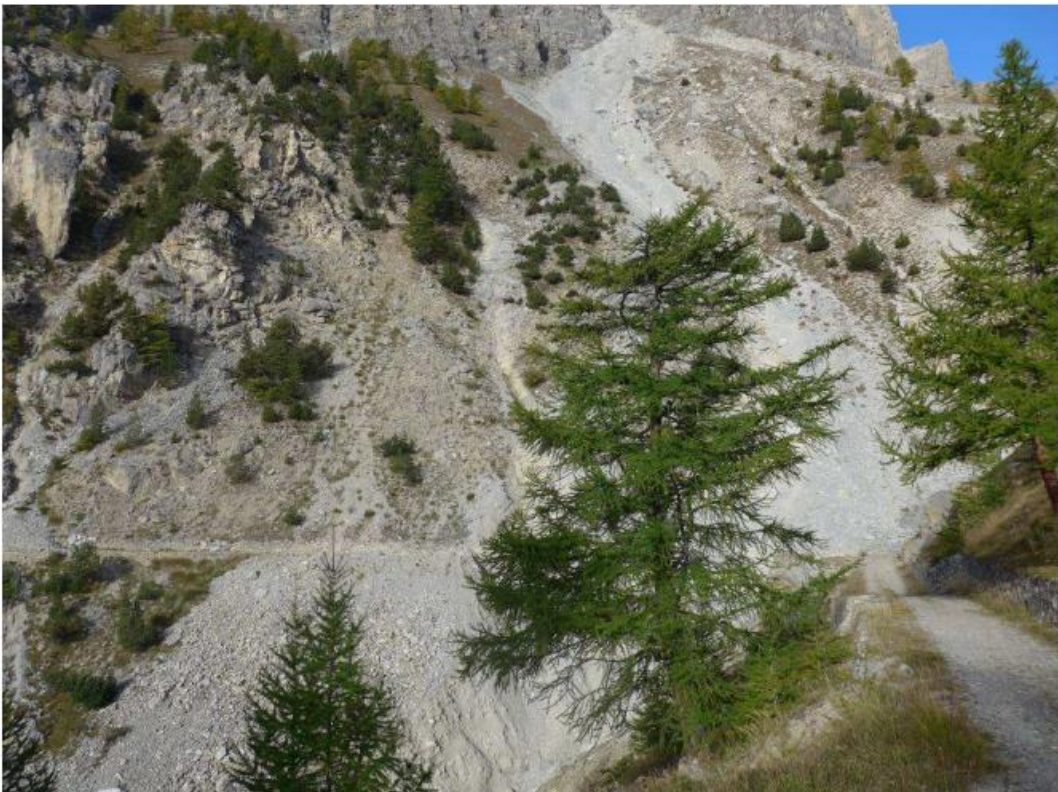
Figura 4.11 La ex strada militare interrotta dalla colata detritica in corrispondenza dell'attraversamento del Rio Inferno.
