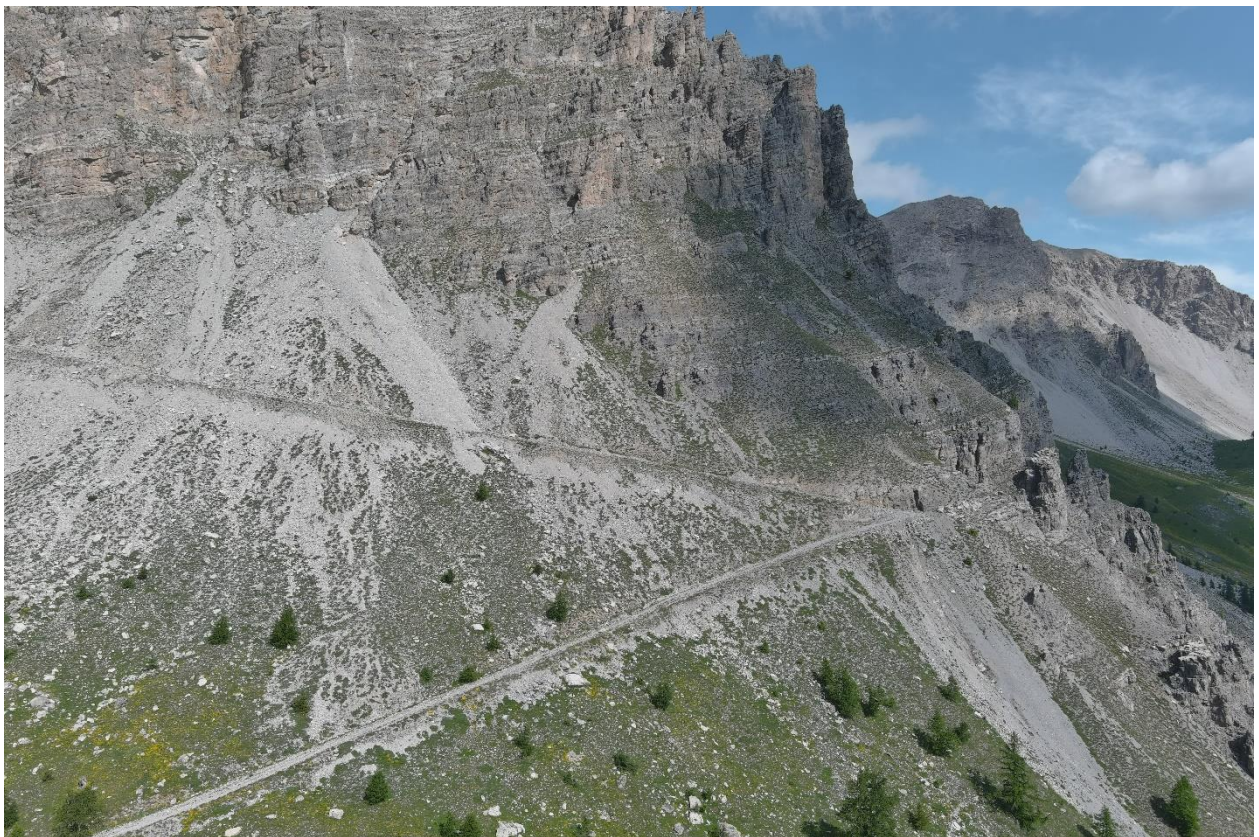
Figura 3.19 Ultimo dei tornanti colpito da fenomeni di crollo. (Foto scattata da drone CFVAS)
