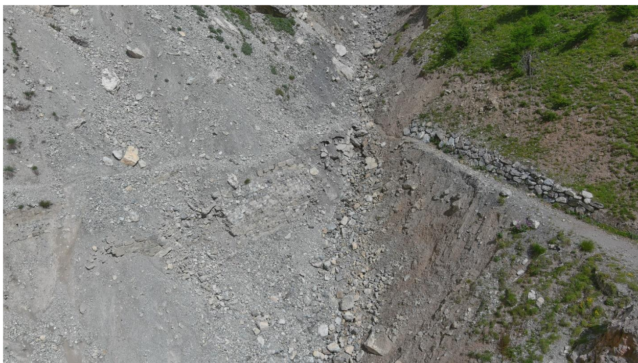
Figura 4.16 Vista frontale del debris flow sul Rio Inferno che attraversa la strada. (Foto del 13/07/2023 scattata dal drone CFVAS – per gentile concessione di Federico Morra di Cella – presidente CFVAS)
