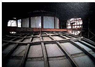
Figure 17. The roof before restoration. Imagine from Il lucernario interno al padiglione, sull'Aula del Parlamento Subalpino, prima del restauro.
