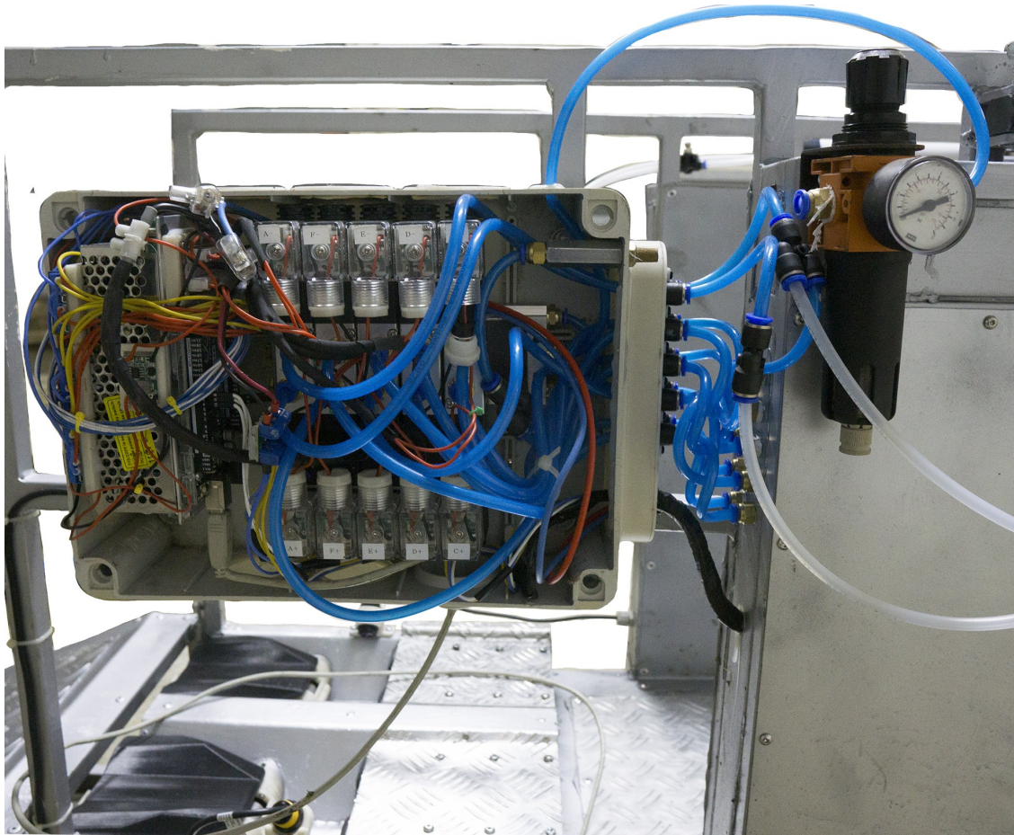
Figura 7.8: Immagine reale del circuito elettro-pneumatico
