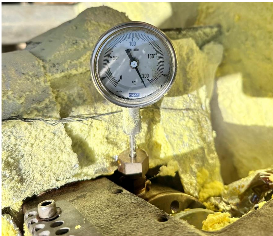
Fig. 4.2.4.1 Termometro installato sulla flangia della tenuta per misurare la temperatura dello zolfo
