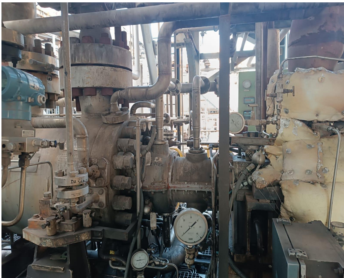
Fig. 4.4.1.1 Turbina a vapore TK-4122 e compressore K-4122
