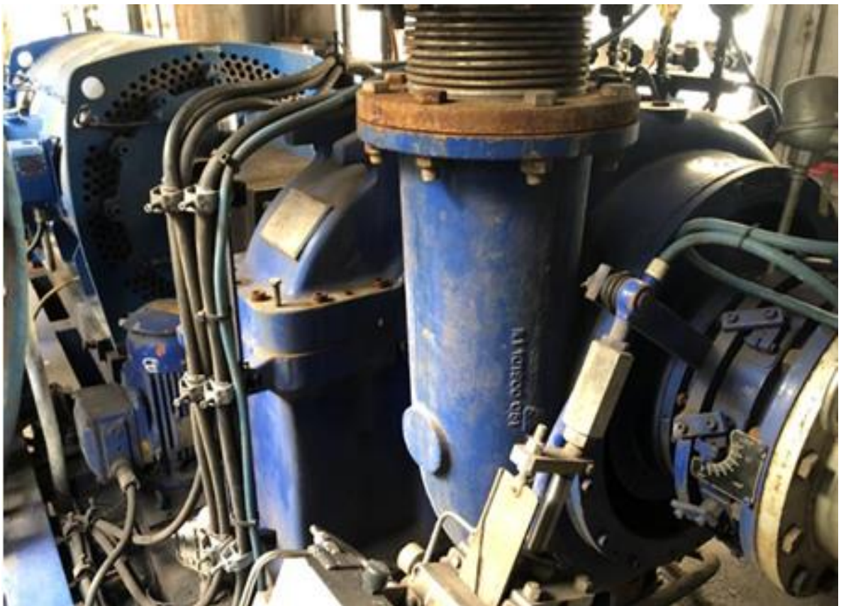
Fig. 4.1.1.1 Compressore centrifugo K-2901 A
