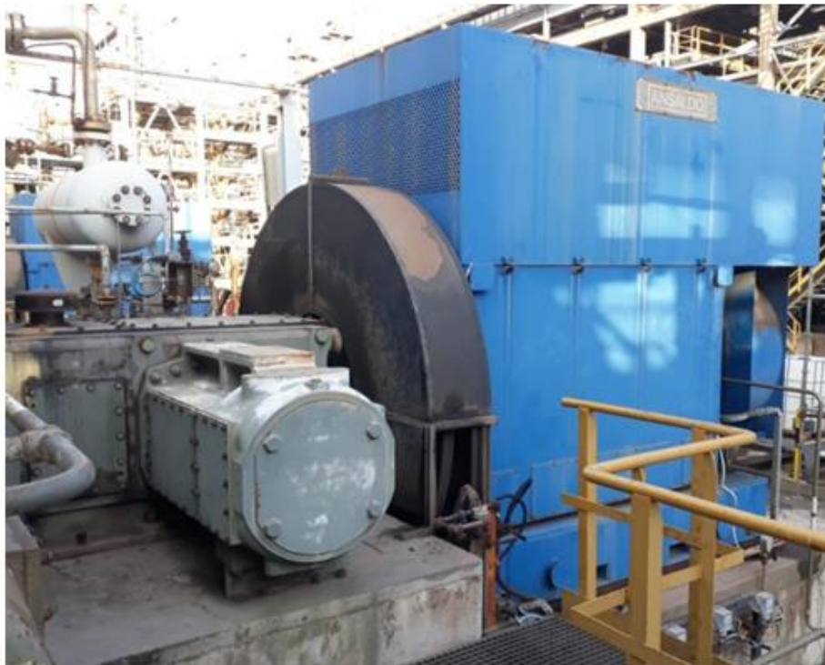
Fig. 4.5.2.3 Motore elettrico del K-4121 A
