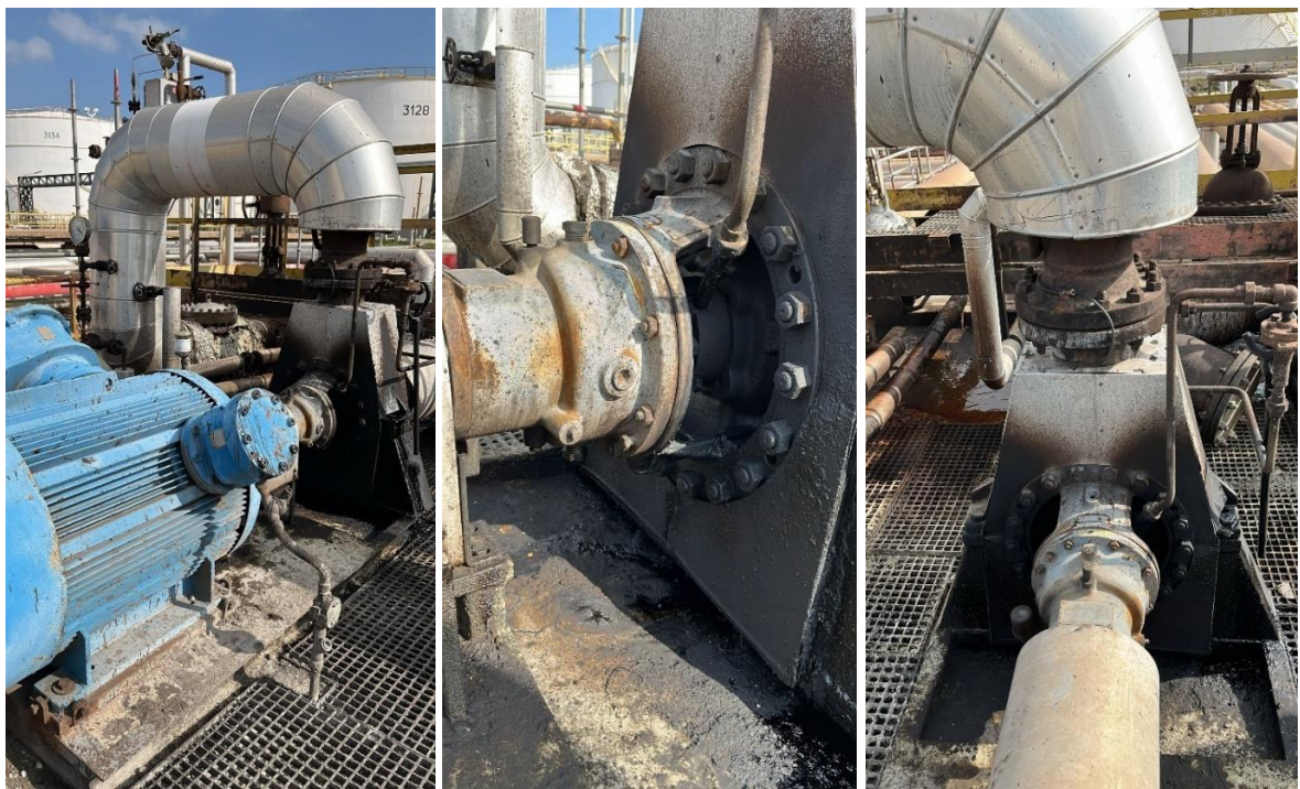
Fig. 4.3.1.2 Pompa P-3290 A (motore elettrico a sinistra e corpo pompa al centro e a destra)
