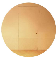
Intonaco sulle porte degli armadi
