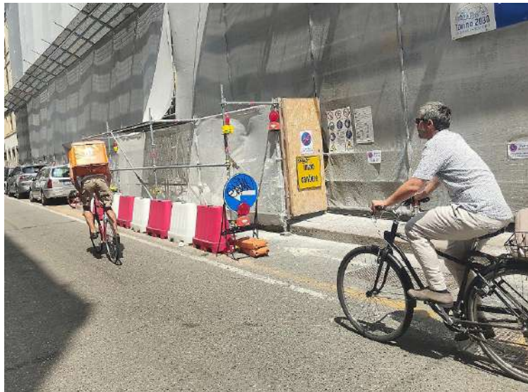
Fig.2 Ciclabile di Corso Principe Amedeo invasa da cantiere di ristrutturazione e da macchine parcheggiate.
