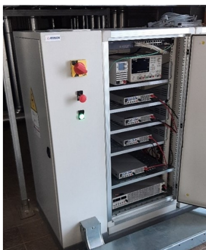
Figura 3.3: Quadro elettrico strumentazione di misura
