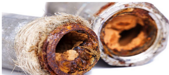
Figura 2.4: Corrosione dei metalli dovuta a correnti galvaniche e/o correnti di dispersione [18].
