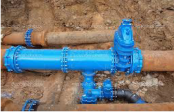
Figura 4.4: Tubazioni rivestite di pittura protettiva [12].
