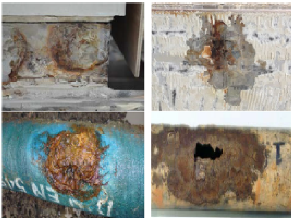
Figura 3.7: Esempi di corrosione da correnti vaganti [34].
