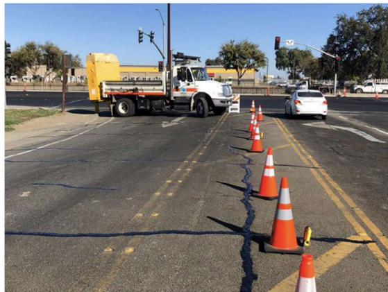
Figura 128_ Installazione dei dispositivi SonoBlaster sui coni di delimitazione della corsia di cantiere
