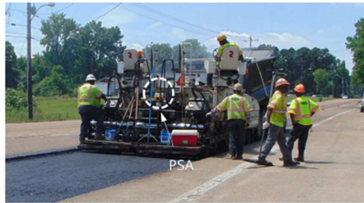
Figura 107_Dispositivo di allarme collettivo (PSA) installato sulla vibrofinitrice
