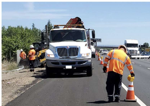
Figura 113_Installazione dei "sensor lamp" sui coni di delimitazione dell'area di cantiere
