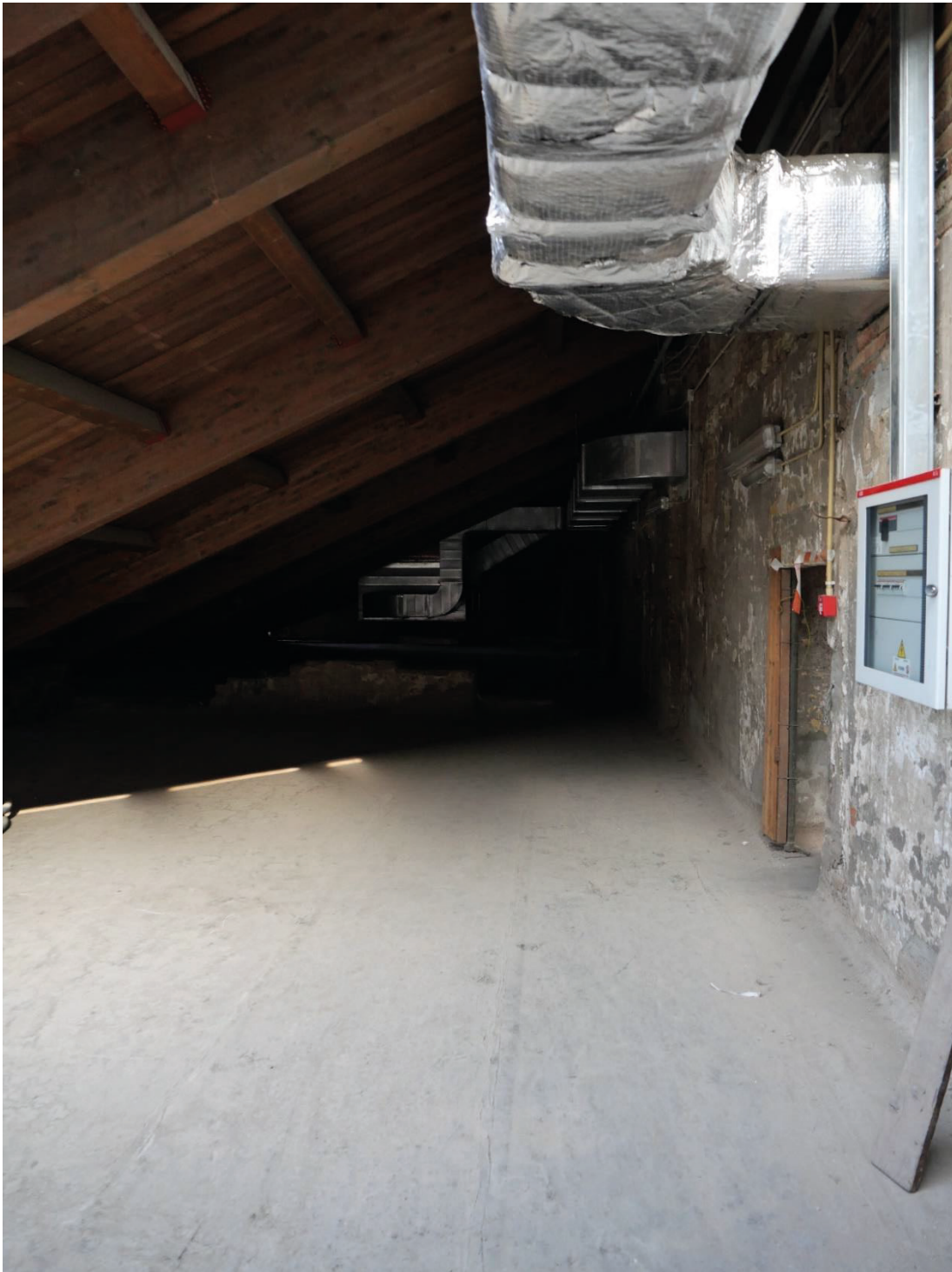
Foto 1, Ala compresa tra Via Cesare Battisti e Via Accademia delle Scienze totalmente occupata da impianti.
