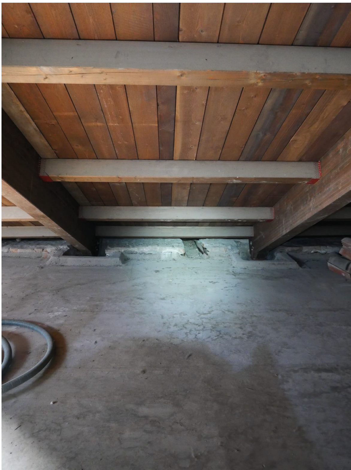
Foto 8, Connessione puntoni-solaio tramite cordolo in cls.
