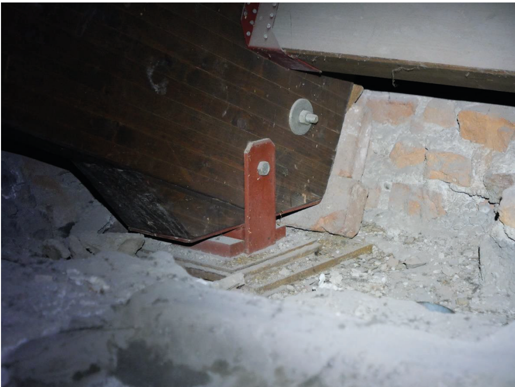
Foto 7, Connessione puntone- solaio
