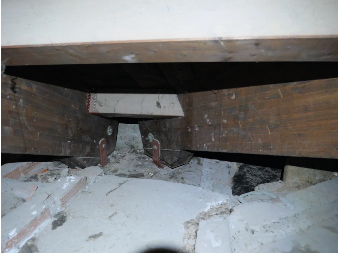
Foto 9, Connessione puntoni-solaio tramite cordolo in cls.
