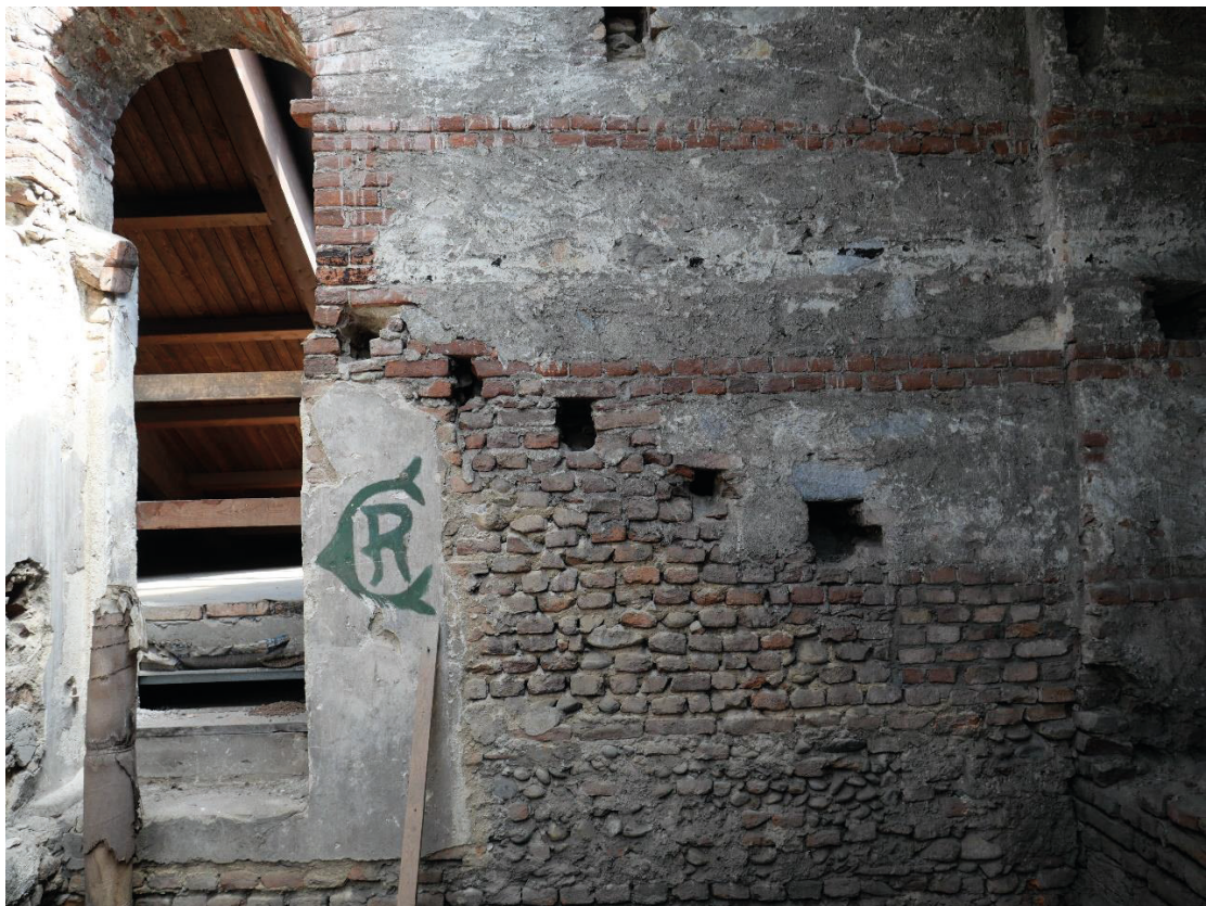
Foto 20, Testimonianza trave di cantonale dell'edificio seicentesco e dell'addossarsi del muro ottocentesco a quello seicentesco.
