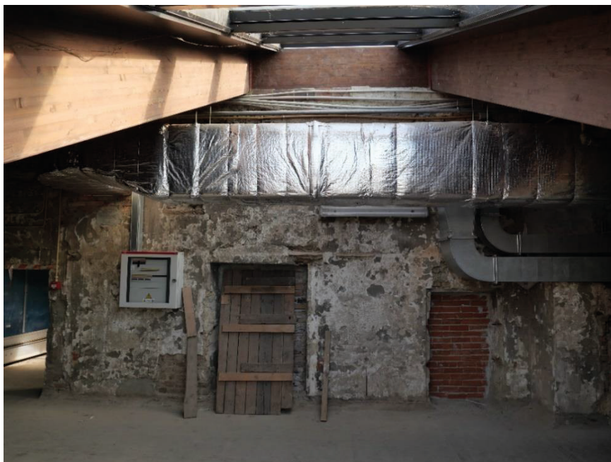
Foto 3, Ala compresa tra Via Cesare Battisti e Via Accademia delle Scienze, particolare estensione degli impianti in quest'area
