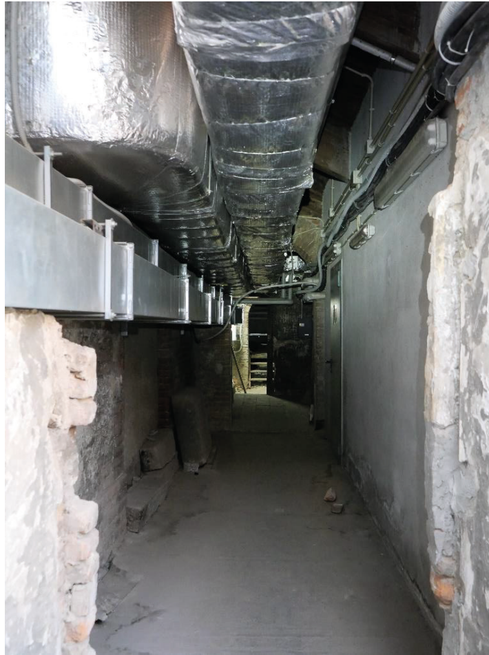
Foto 2, Ala compresa tra Via Cesare Battisti e Via Accademia delle Scienze, particolare estensione degli impianti in quest'area
