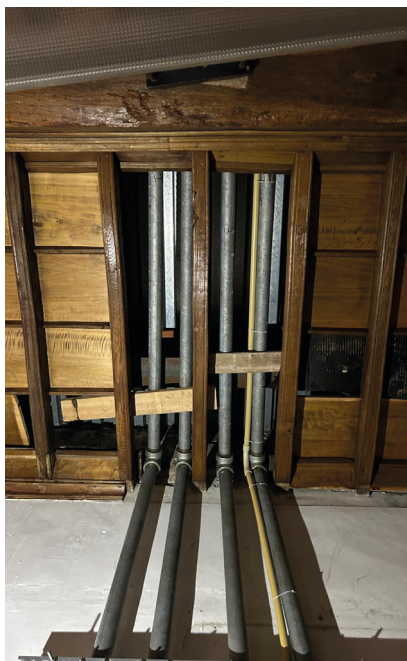
Figura 51 il solaio originario è usato come controsoffitto mentre l'intercapedine per il passaggio degli impianti (foto scattata durante il sopralluogo ad Aprile 2024)
