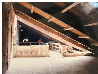
Figura 19 Porzione destra dell'ambiente del sottotetto completata per prima con la nuova copertura in legno lamellare. (IUAV, Archivio Progetti, Fondo Andrea Bruno, Scatola F4)
