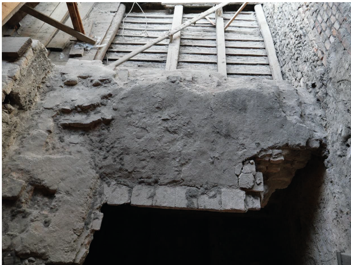
Foto 22, Cornicione dell'edificio seicentesco
