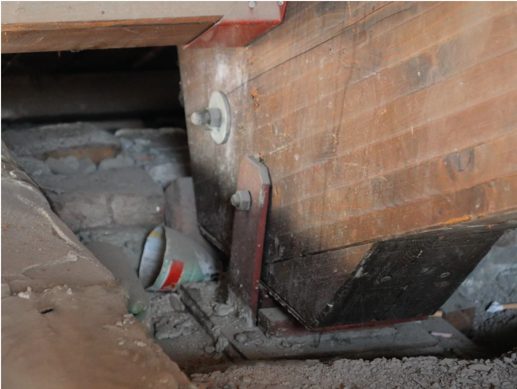
Foto 6, Connessione tra il puntone della copertura e la struttura del solaio a cui è agganciata tramite un appoggio scorrevole.
