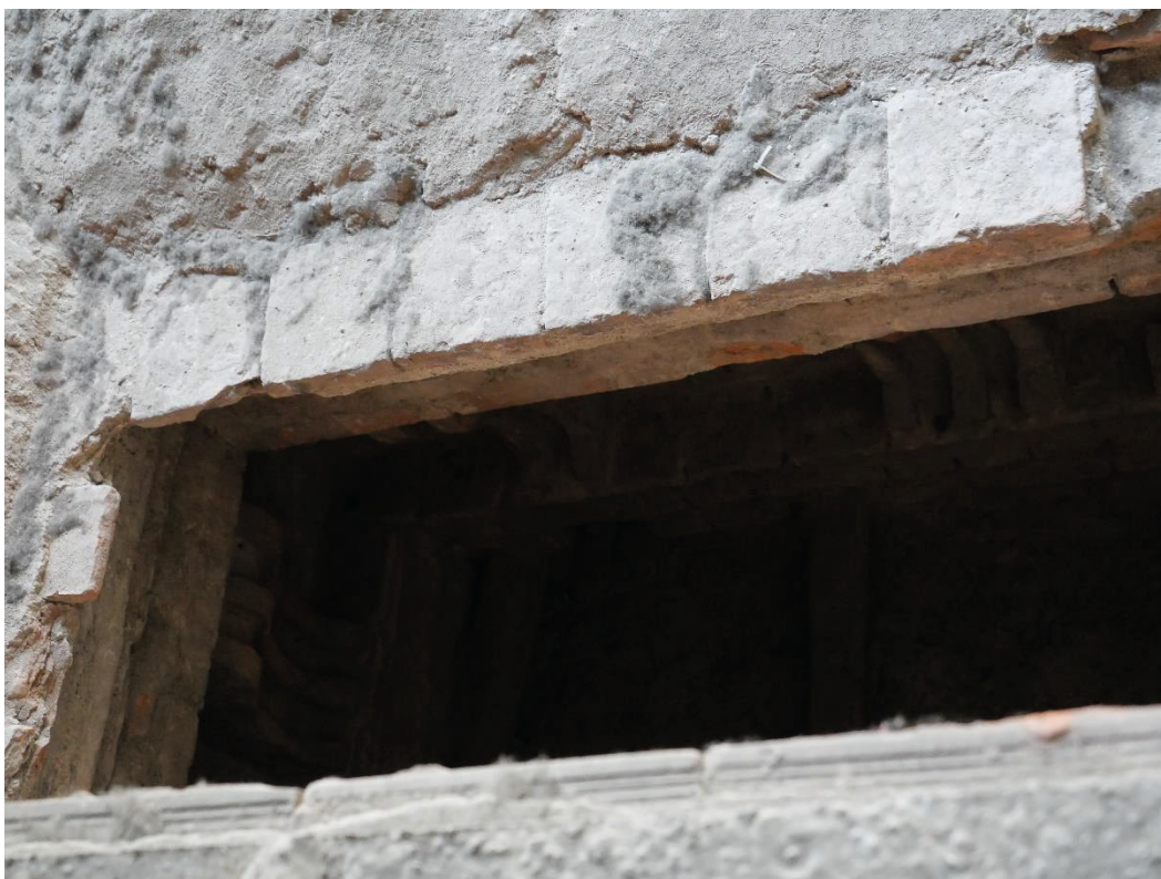
Foto 23, Cornicione dell'edificio seicentesco
