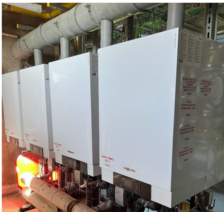
Figura 31 - Generatori di calore modulari – RSA Cervetto
