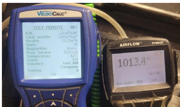
Figura 41 – Valori ramo di mandata - Test della rete aeraulica
