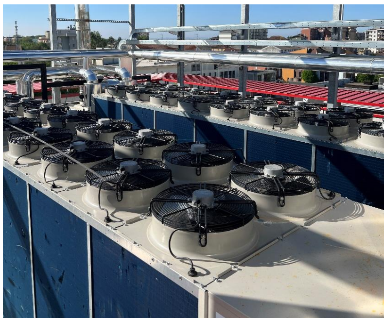
Figura 29 - Ventilatori Pompe di calore (lato aria) – RSA Cervetto
