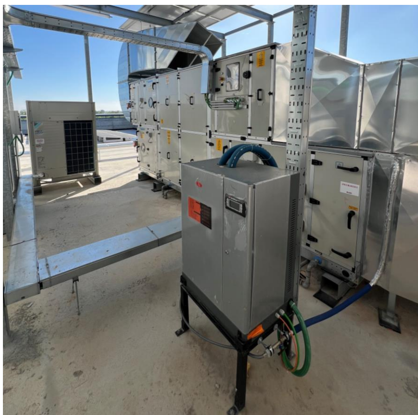
Figura 38 - UTA.03 (con Umidificatore e Sistema ad Espansione diretta)
