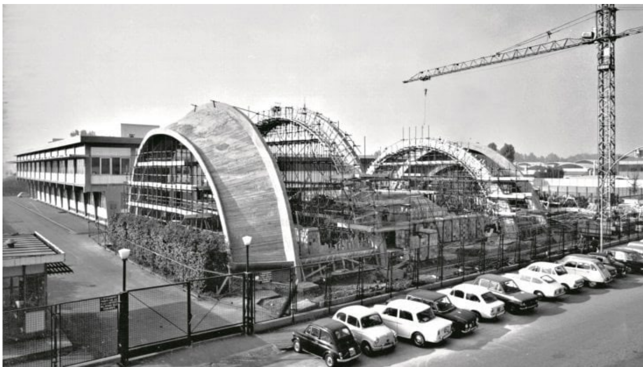
Fig.5.12: Costruzione della galleria del vento dell'industria Pininfarina a Grugliasco, trasferitasi nella "cintura" nel 1958, foto da: repubblica.it , Anniversari. Quando l'uomo inventò il vento , 20 giugno 2022.
