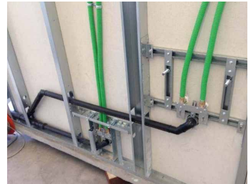
fig 81: dettaglio degli impianti inseriti nelle pareti dei moduli bagno, realizzati in stabilimento fonte: Massimo Scartezzini. (2018). La residenza Universitaria Mayer—Trento Il progetto tra architettura e struttura. Ciclo di seminari tecnici, fabbricalegno.
