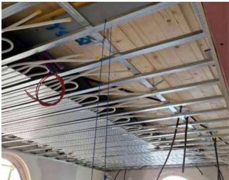
Fig. 38: Controsoffitto radiante fonoassorbente
