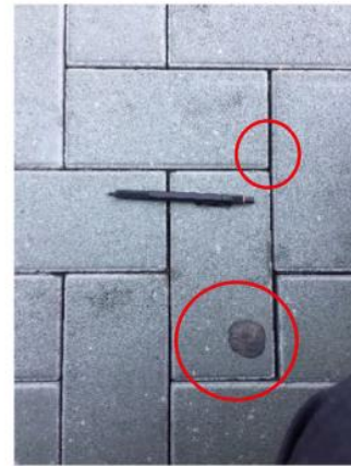
(d) Surface dirt and joint sand loss on the block layer
