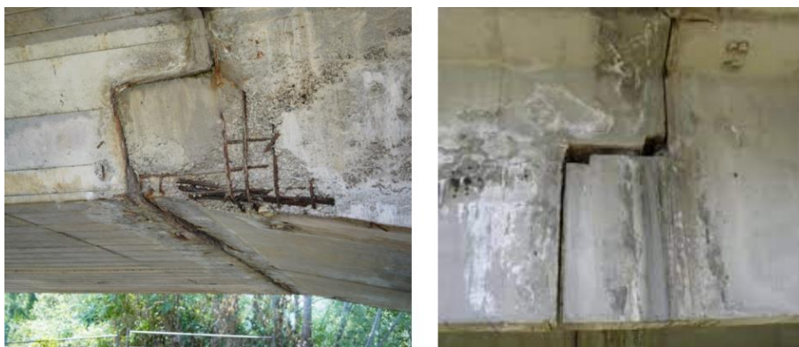
Figura 3: Esempio selle Gerber soggette a corrosione [9]
