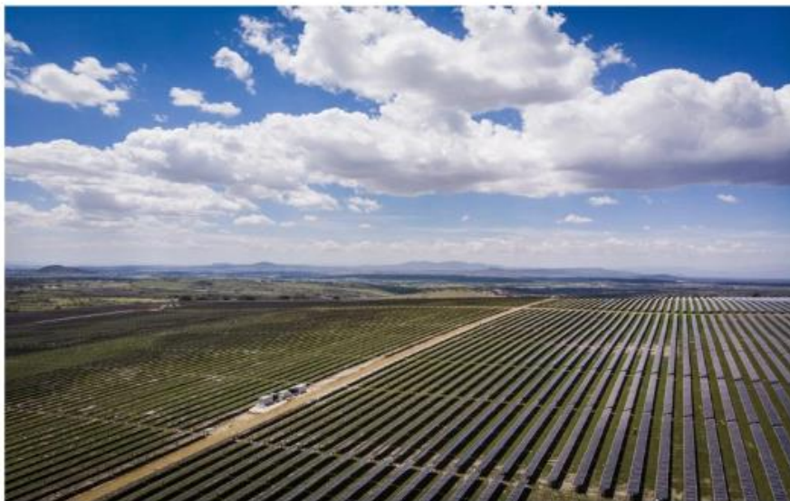
Figura 17 - Impianto di energia solare Engie in Brasile [66]
