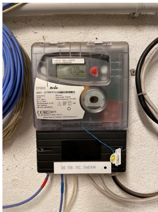
Figura 16 – Misuratore di energia termica 11B-11C
