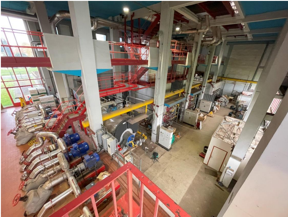
Figura 12 - Centrale termica teleriscaldamento
