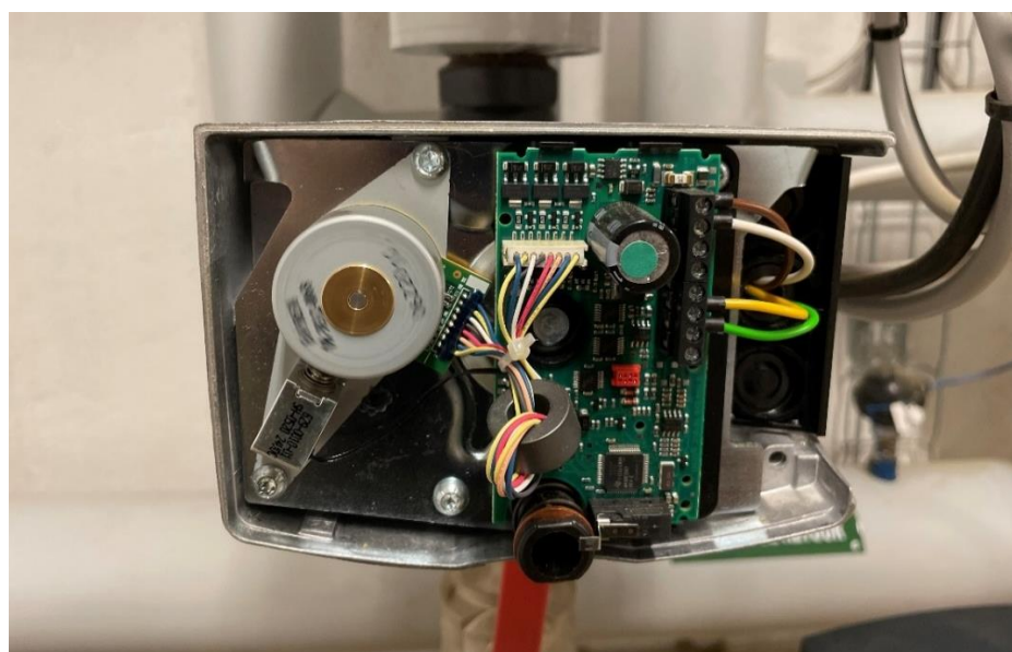
Figura 19 - Collegamento servomotore Schneider
