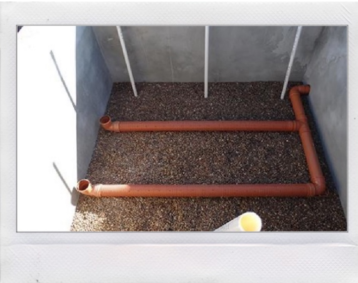
Fig. 8. Vista del tubo di uscita, dove i tubi devono essere collegati in modo da lavorare a pressione atmosferica per evitare tenute idrauliche che ostacolano il drenaggio della zona umida. Ing. Fernando Raffo.
