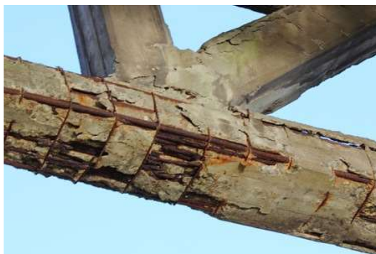
Figura 2 - Trave di cemento armato che, a causa della degradazione, espone le armature ad attacchi chimici causando la formazione di ruggine.
