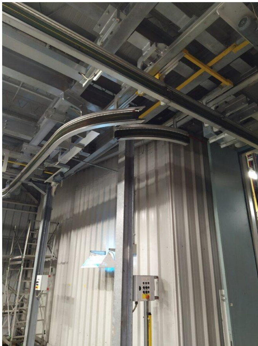
Figura 16. Magazzino Automatico struttura
