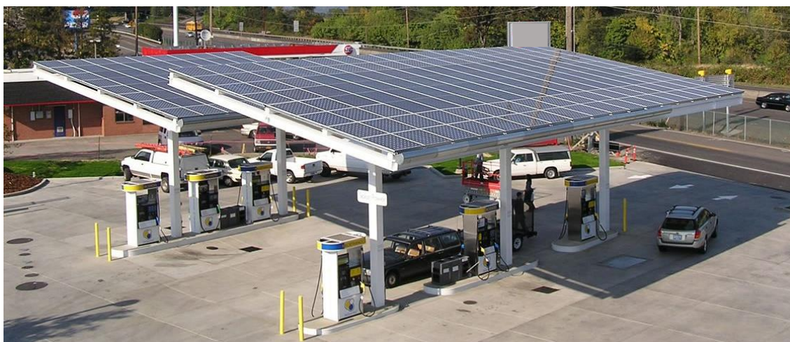
Figura 6 - Impianto fotovoltaico su pensilina
