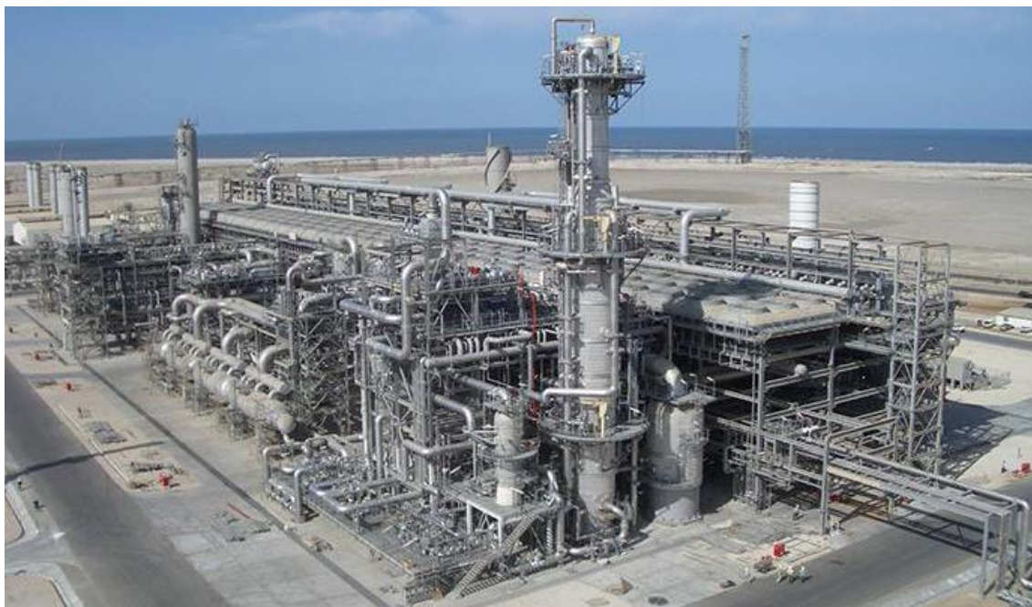
Figura 2 - Impianto di liquefazione della SEGAS a Damietta, Egitto
