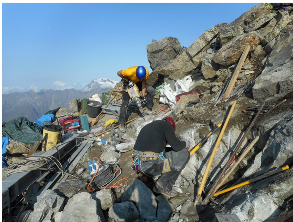
Fig. 14 | Cantiere bivacco Pasqualetti sulla cresta del Morion, Valpelline Ao, 2017; operai si apprestano a forare le rocce per alloggiare barre filettate che assolveranno il compito di reggere l'intera struttura e mantenerla ancorata a terra
