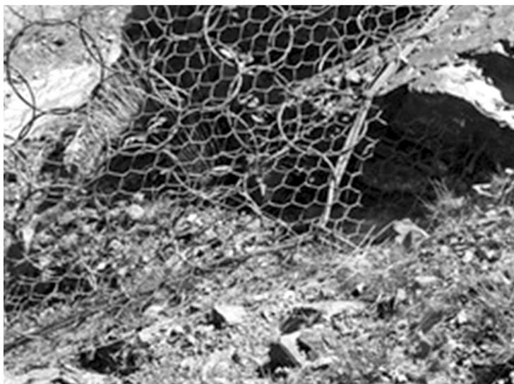
Figura 85: Esempio di varco al piede ripristinato in modo difforme. [61]
