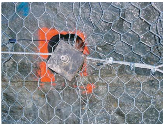
Figura 74: Stato deformativo in prossimità del sistema di ancoraggio. [62]
