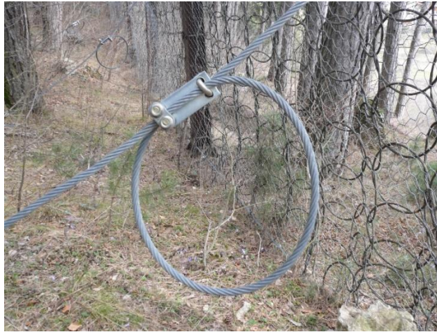
Figura 28: Particolare di dissipatore. [14]
