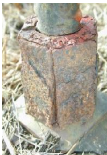
Figura 94: Dado di ancoraggio corrosivo. [65]
