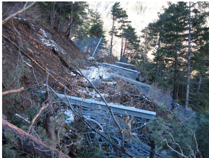
Figura 79: Barriera distrutta da evento di caduta massi.[24]
