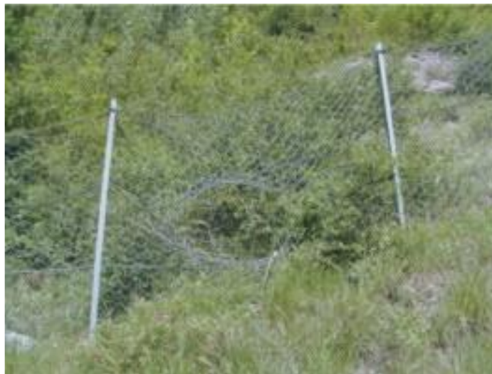
Figura 80: Perforazione dovuta a blocco con livello di energia troppo elevato. [65]
