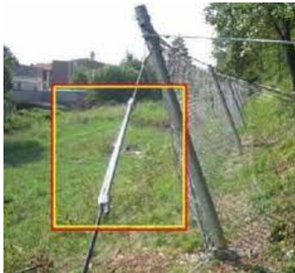
Figura 29: Particolare di dissipatore [15]
