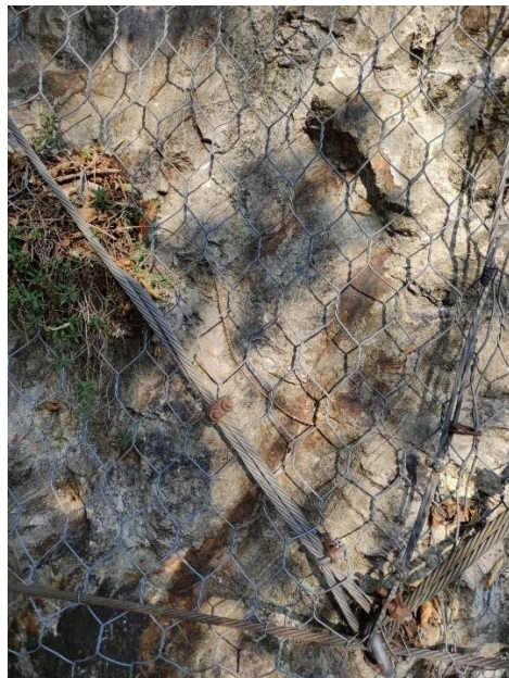
Figura 95: Dettaglio di morsetti corrosi.
