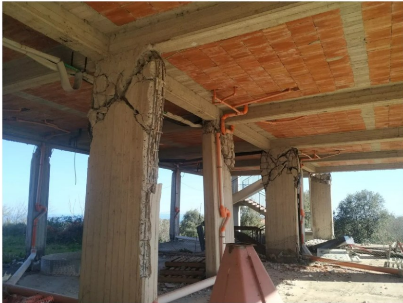
Figura 29 - danneggiamenti a strutture verticali su edificio in costruzione(ingvterremoti.com [8]).
