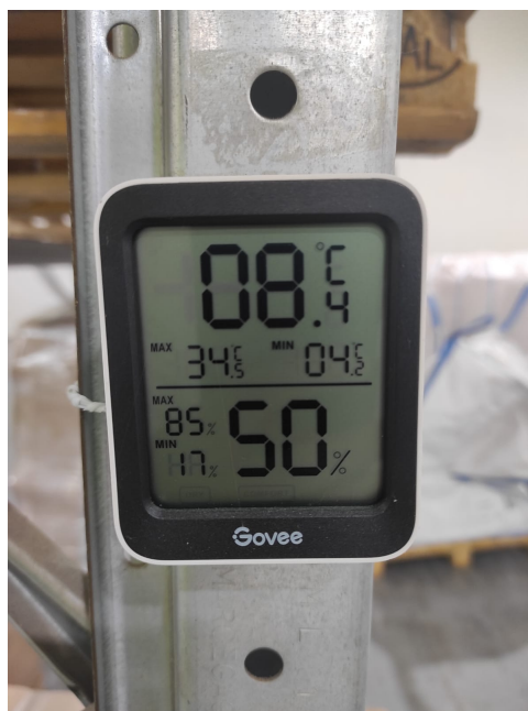
Figura 5.6. Monitor per monitorare umidità e temperatura ambiente magazzino
