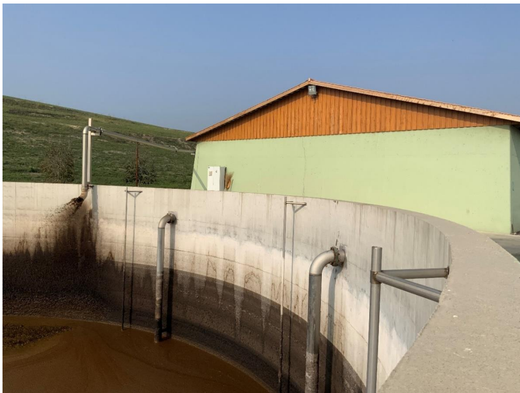
Fig. 4.29 Stoccaggio digestato liquido
