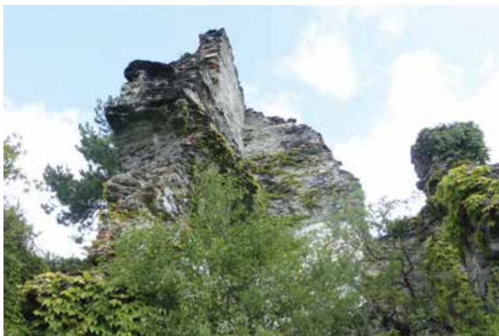
Foto 4 Ciò che resta della timpanatura della chiesa; rimane parte dello scheletro che ben evidenzia lo spessore del semi pronao della facciata
