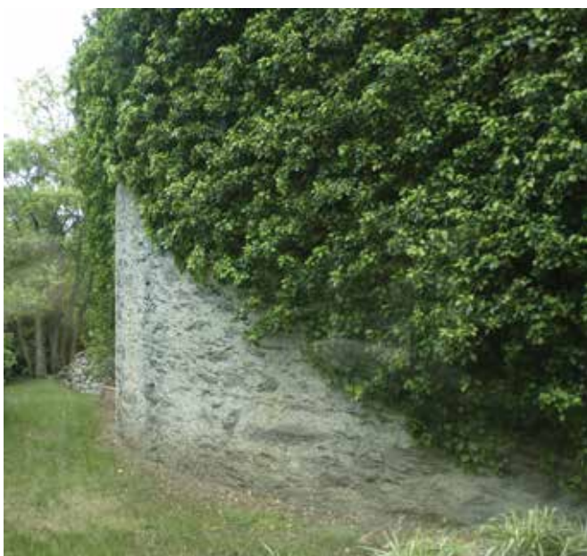
Foto 12 Ciò che rimane della muratura esterna dell'abside della chiesa. E' evidente come la muratura semicircolare della parte più bassa fosse staccata da una copertura e che lo sviluppo andasse digradando nella parte più alta, foto scattata il 15/05/20.
