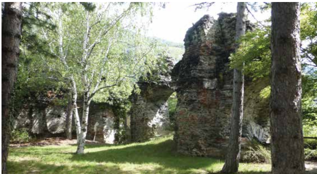
Foto 30 Vista d'insieme dell'interno di levante verso l'abside, poco prima di esso si sviluppava un transetto che per il questo lato della chiesa è stato completamente raso al suolo, foto scattata il 25/05/20.
