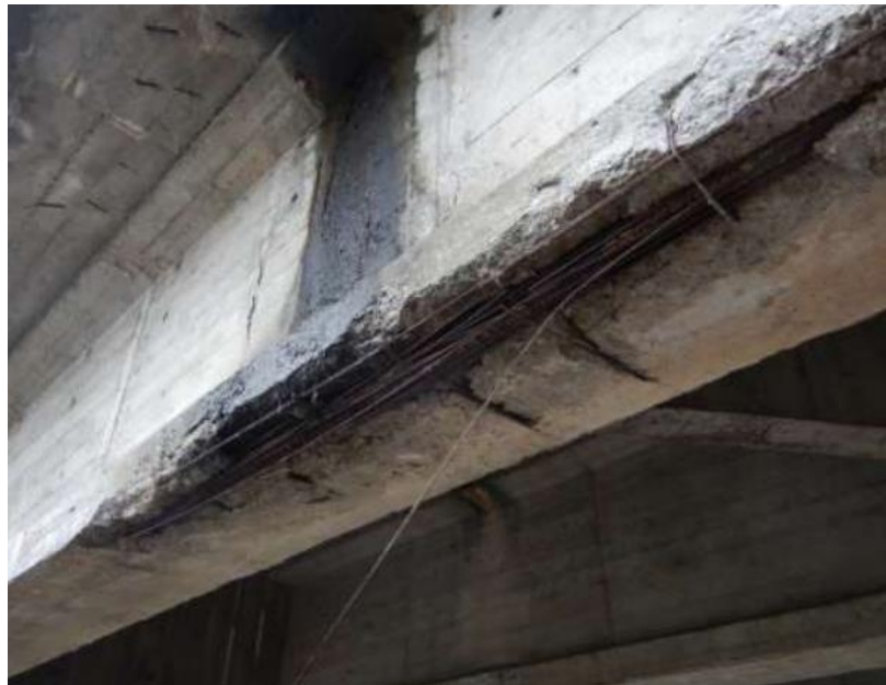
Figura 14 - Degrado armatura da precompressione
