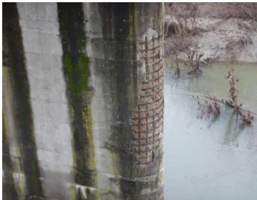
Figura 15 - Armatura esposta di una pila
