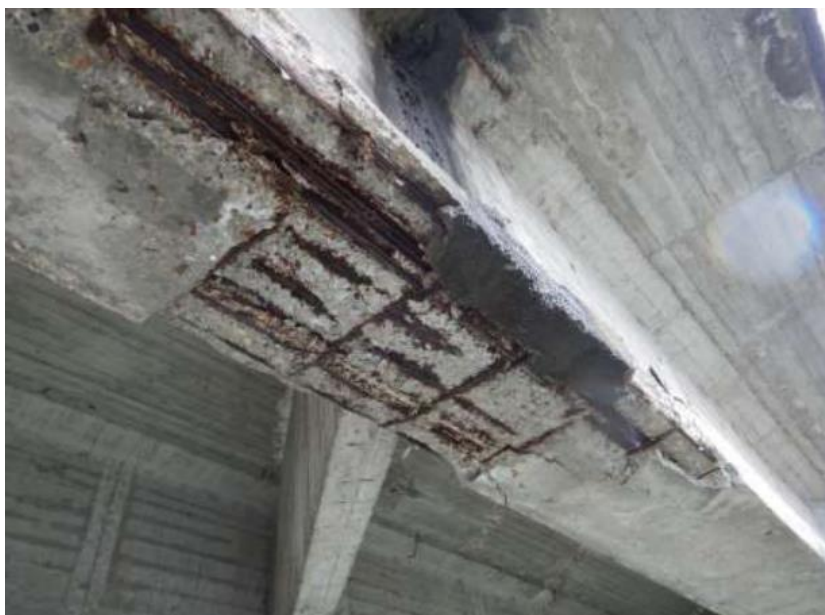
Figura 16 - Degrado armatura di una trave
